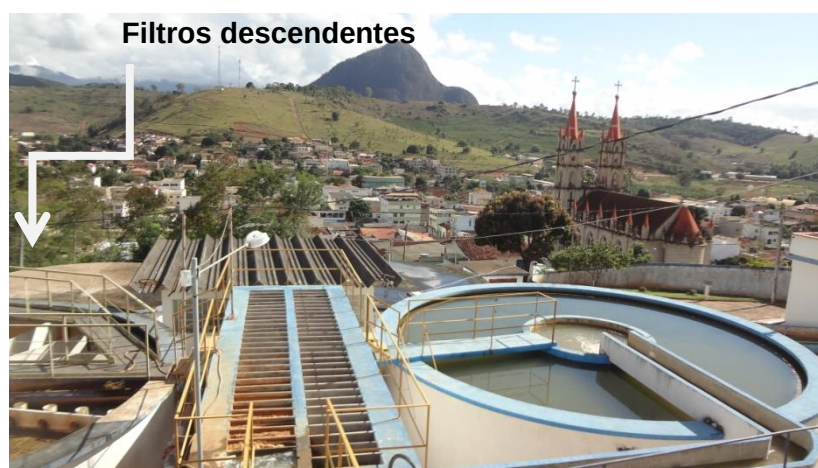
Figura 3-40 - Estação de Tratamento de Água de Itaguaçu.
