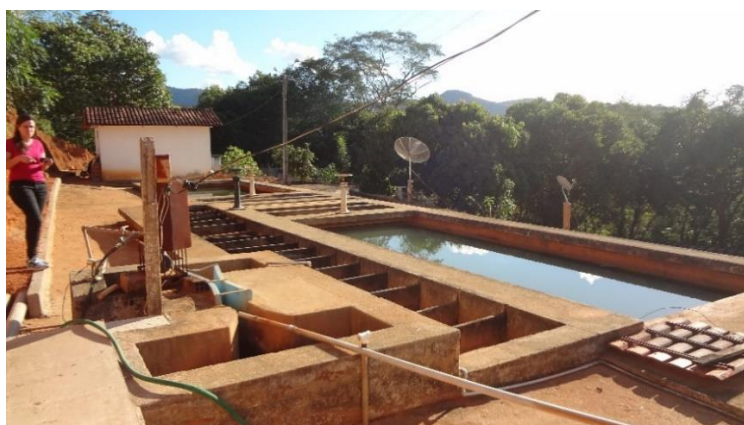
Figura 3-41 - Estação de Tratamento de Água Itarana.
