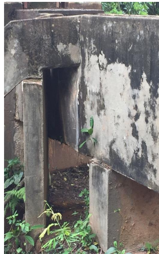
Figura 5 – Estrutura com fissura.
