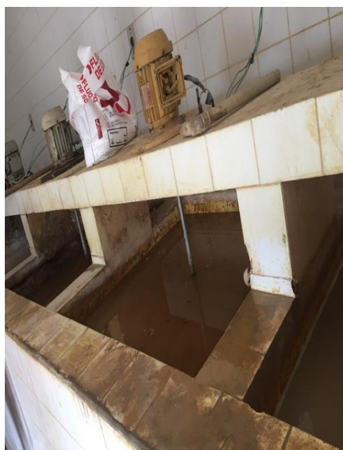
Figura 11– Tanque de Mistura
