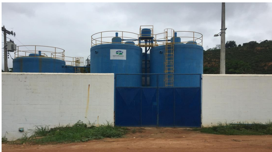
Figura 27 – ETE de Itarana
