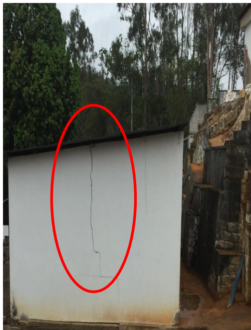
Figura 20 – Fissura exposta na filtração.
