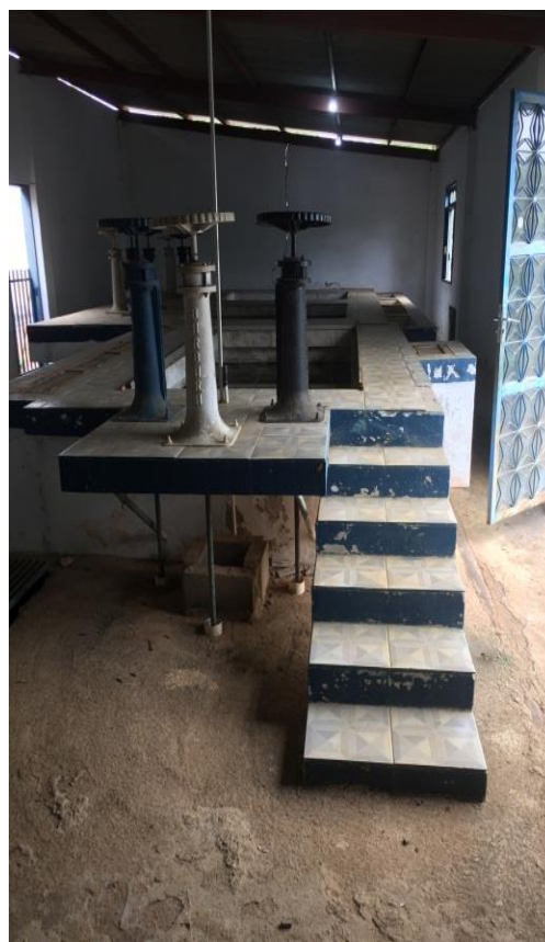
Figura 18 – Escadas para acesso aos filtros.
