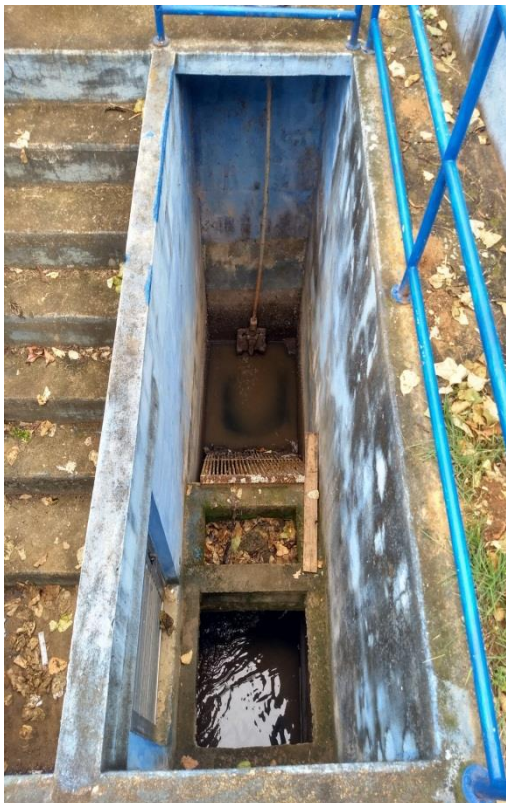
Figura 35.1 - Pré Tratamento da EEEB.
