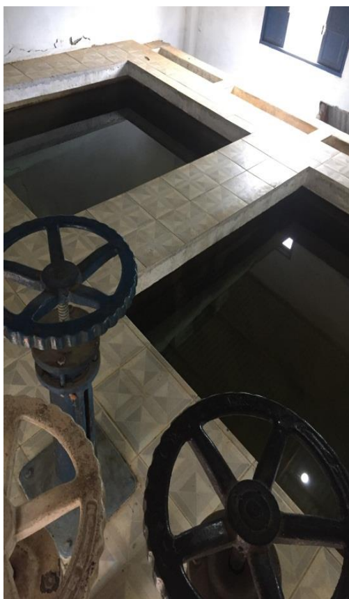
Figura 17 – Filtros ETA Itarana.
