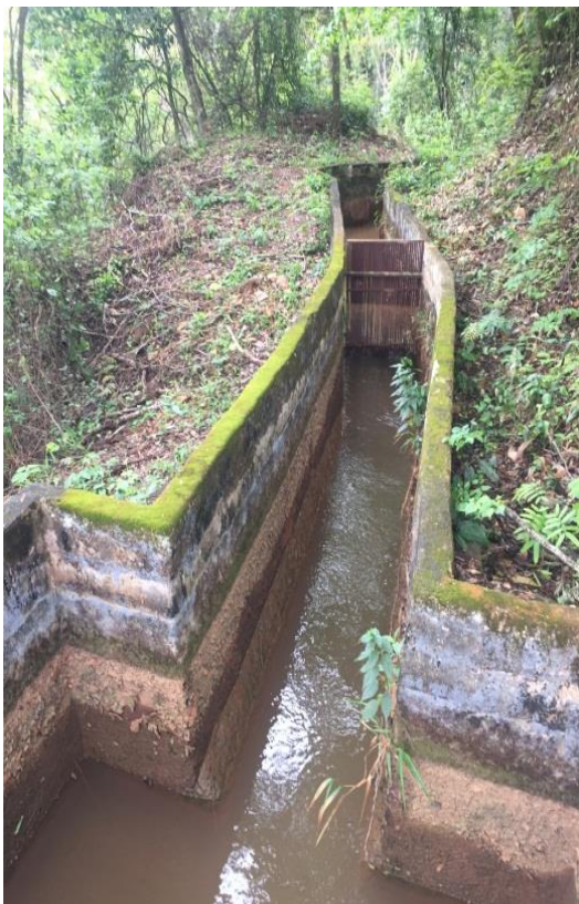
Figura 4 – Crivo no final do Canal
