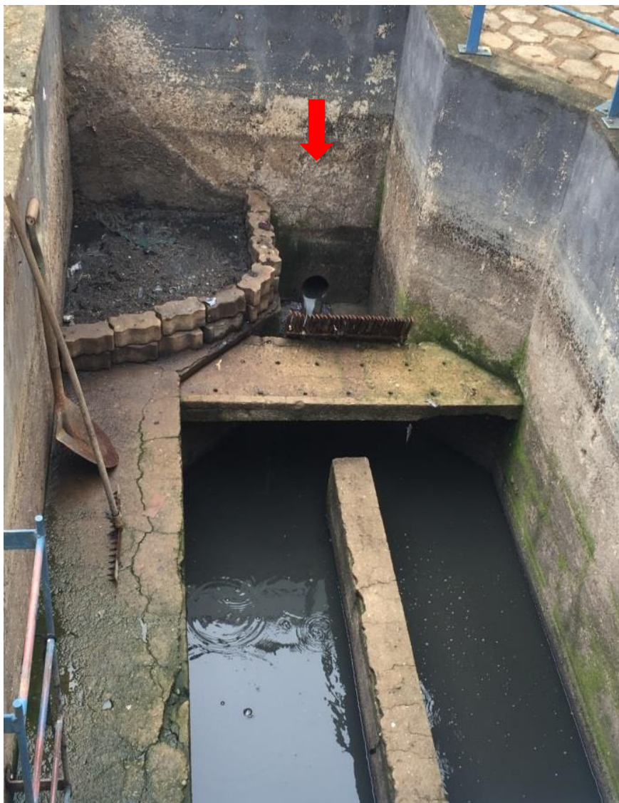
. Figura 30 – Chegada de esgoto bruto.
