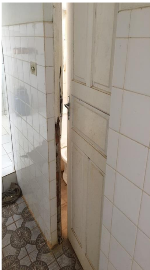
Figura 22 – Porta do banheiro danificada
