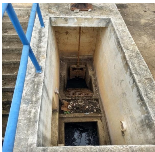
Figura 29.1 – Pré Tratamento da EEEB.
