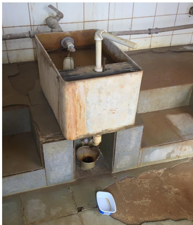
Figura 14 – Dosador de flúor.
