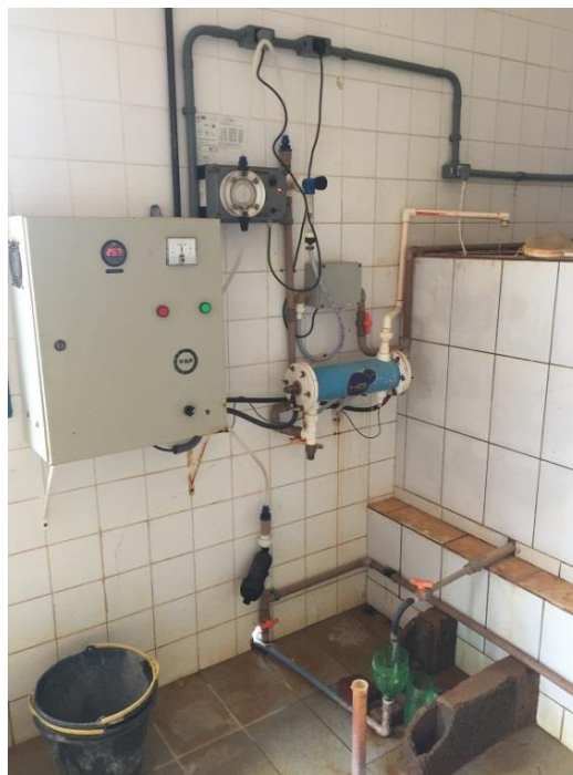
Figura 13 – Dosador de Cloro.
