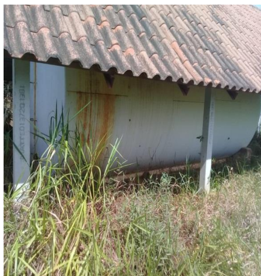
Figura 24 – Excesso de Vegetação
