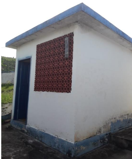
Figura 32 – Casa de Bomba EEAT da ETA.
