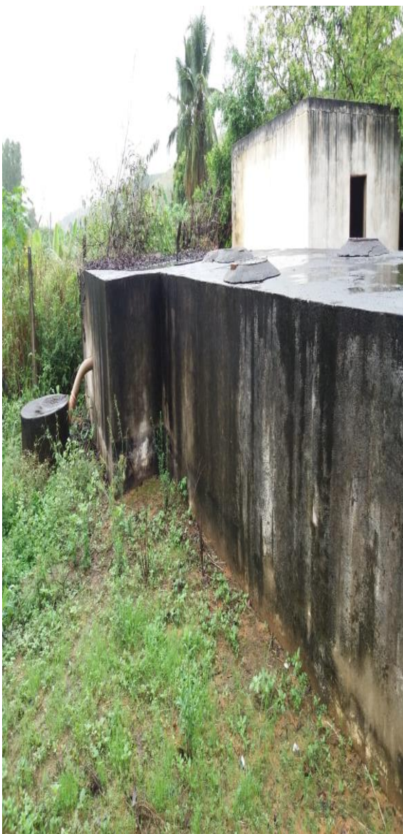
Figura 141 – Excesso de Vegetação.
