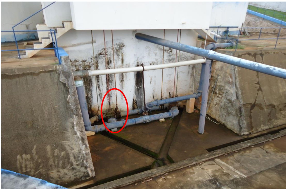
Figura 20 – Tubulação com Vazamento.
