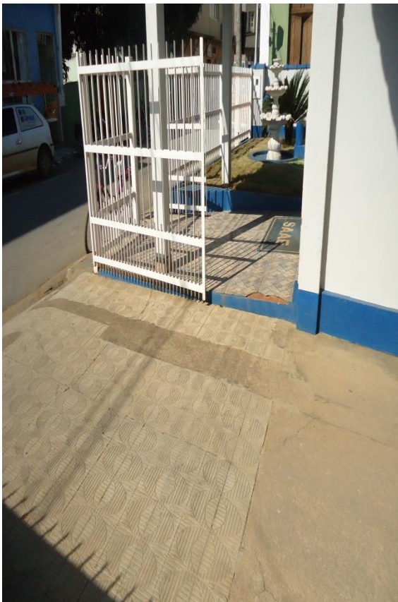
Figura 150 – Falta de Acessibilidade na lateral.
