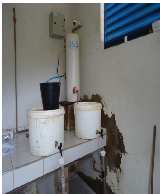
Figura 75 – Dosagem do Flúor e Cloro.
