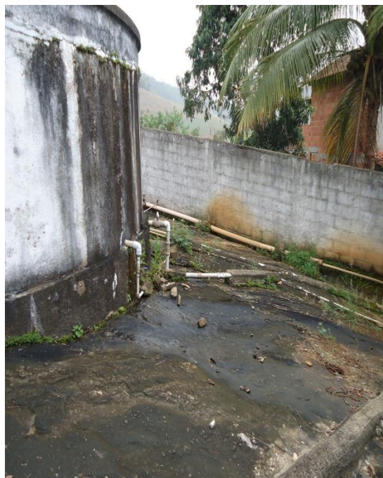
Figura 85– Reservatório 1 com Vazamento.
