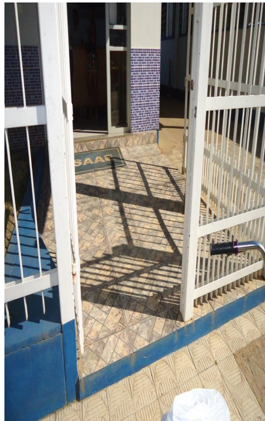
Figura 151 – Falta de Acessibilidade.
