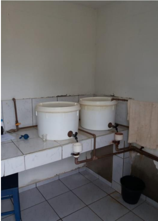
Figura 92 – Dosadores de Flúor e cloro.
