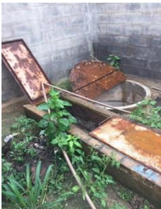
Figura 162 – Excesso de Vegetação.
