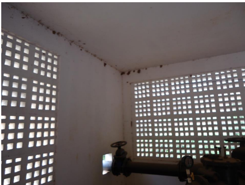
Figura 5 - Paredes da EEAB da Sede de Itaguaçu necessitando de limpeza.
