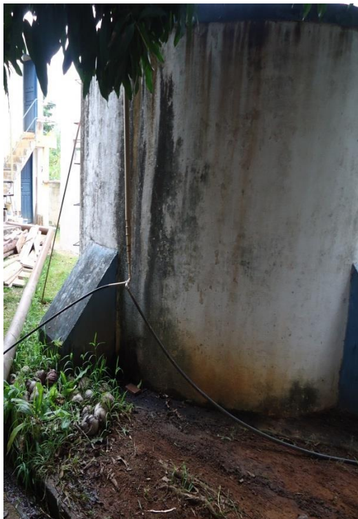
Figura 64 – Reservatório 1 da ETA Itaimbé.
