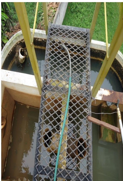
Figura 79 – Excesso de Lodo e corrosão.
