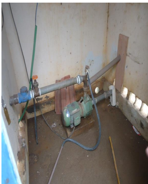
Figura 49 – Conjunto Moto-Bomba EEAT.
