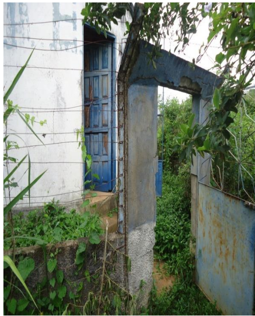
Figura 57 – Excesso de Vegetação.
