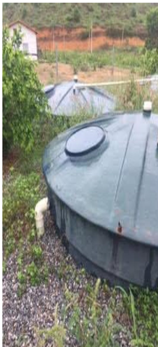
Figura 157 – Excesso de vegetação.
