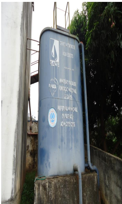
Figura 77 – Unidade de Tratamento ETA.
