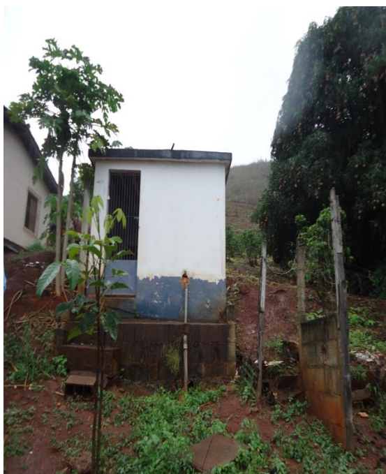
Figura 40 – Casa de bomba EEAT Florêncio
