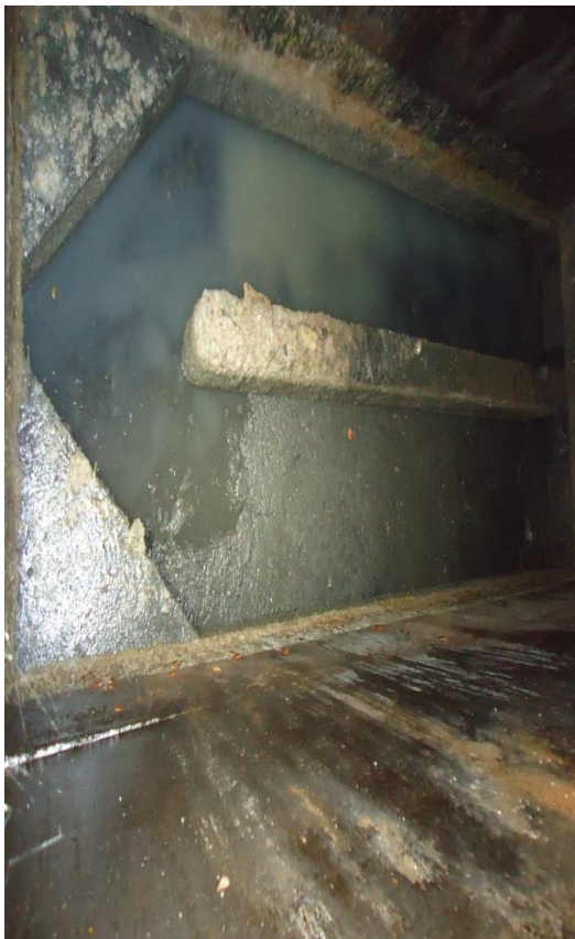
Figura 104 – Caixa de desarenadora.
