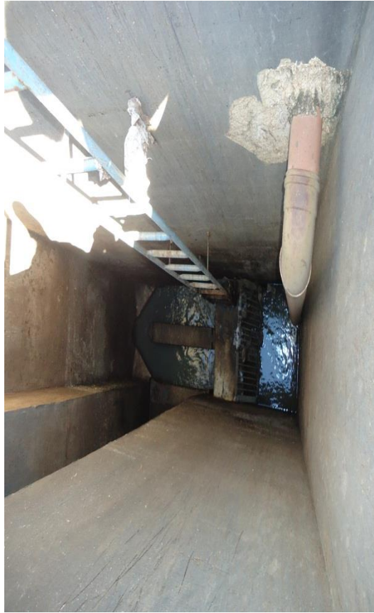
Figura 116 – Entrada do Efluente.
