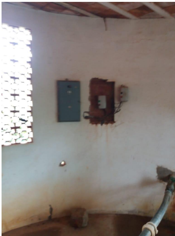
Figura 89 – Painel de Controle EEAB.
