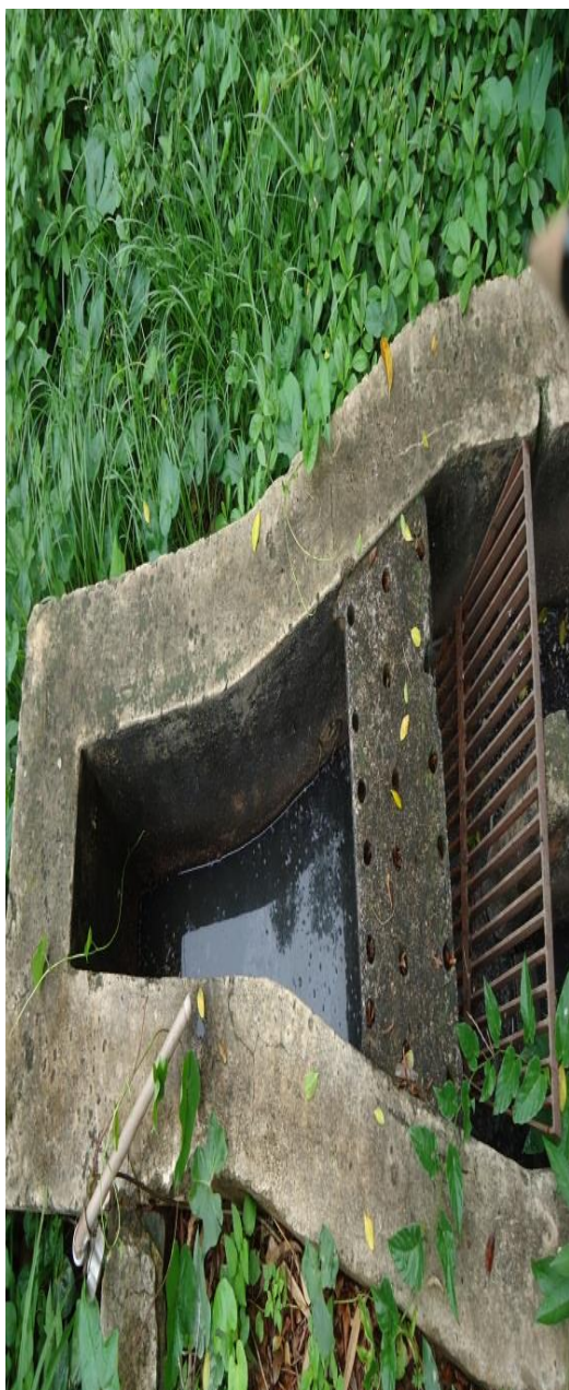
Figura 135 – Excesso de Vegetação.
