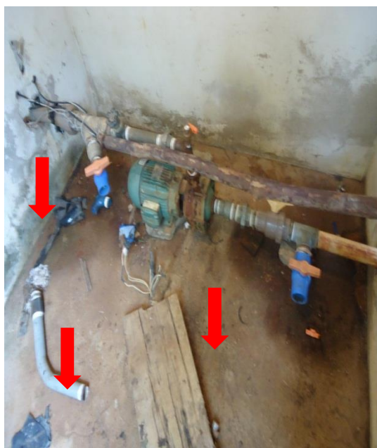
Figura 52 – Conjunto moto-bomba EEAT
