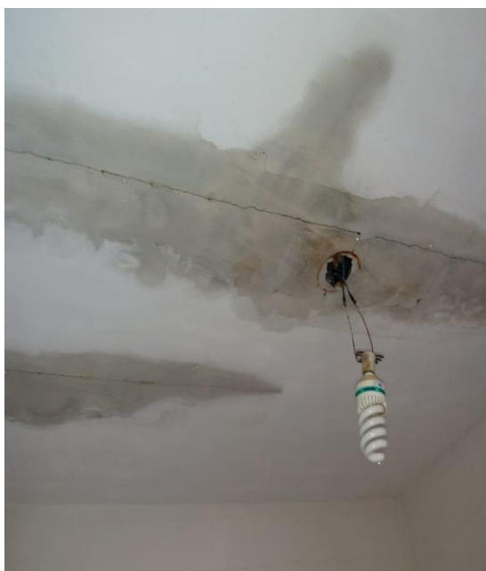
Figura 96 – Infiltração no teto da ETA Itaçu.
