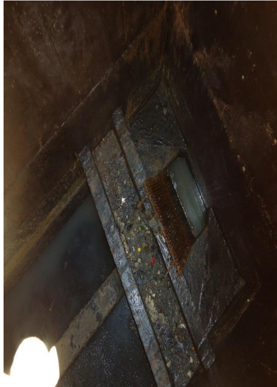
Figura 103 – Entrada do Efluente.
