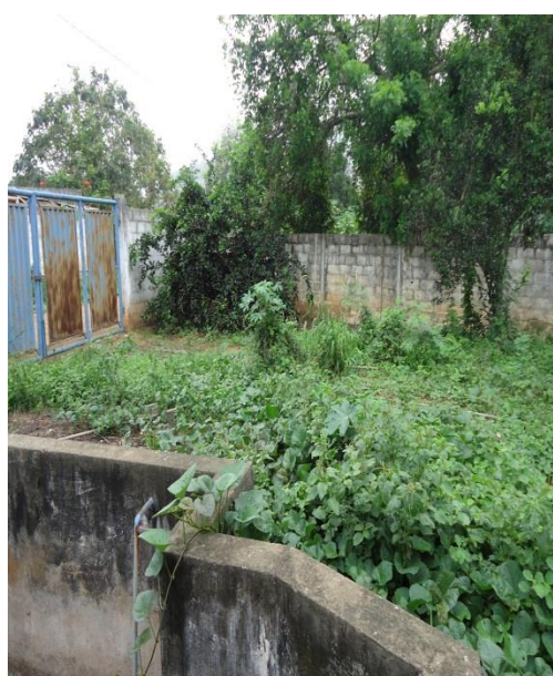
Figura 132 – Excesso de Vegetação.
