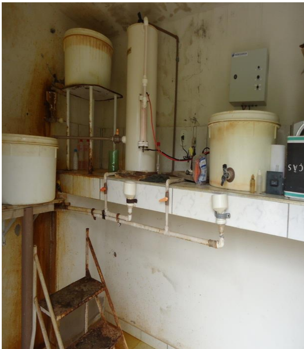
Figura 59 – Dosadores de Cloro, Sulfato e Flúor.
