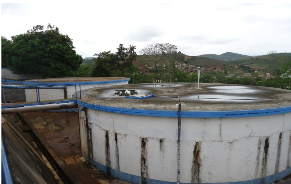
Figura 36– Reservatório 1 e 2 com fissura.
