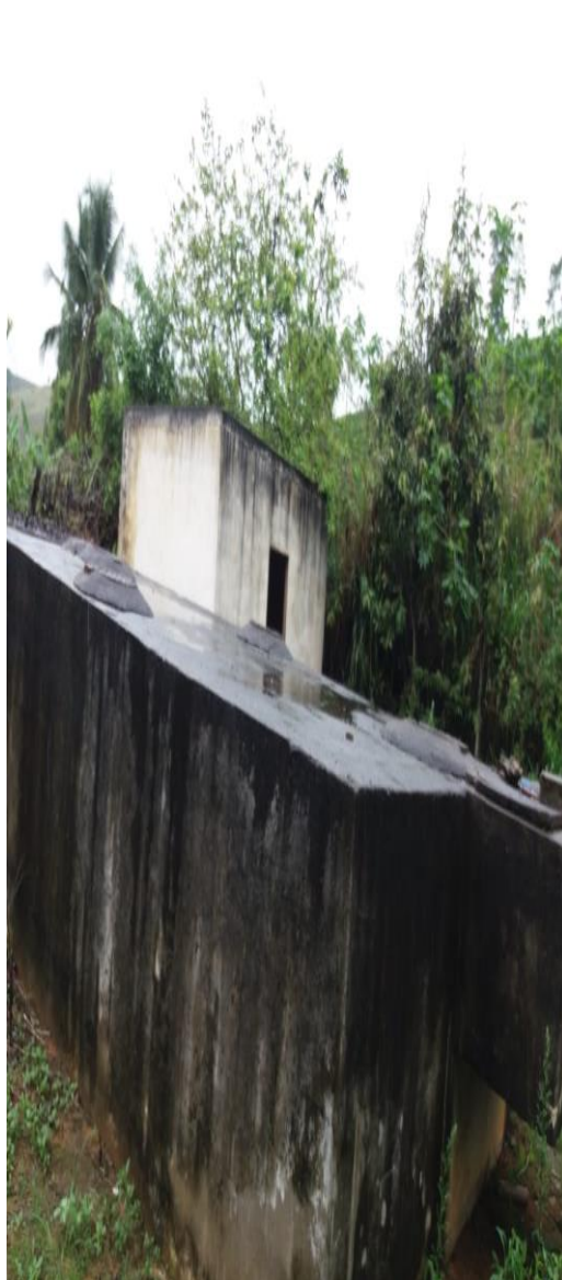
Figura 142 – Fossa Séptica Itaçu.
