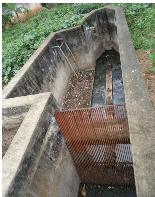
Figura 133 – Pré Tratamento do Distrito Itaimbé.
