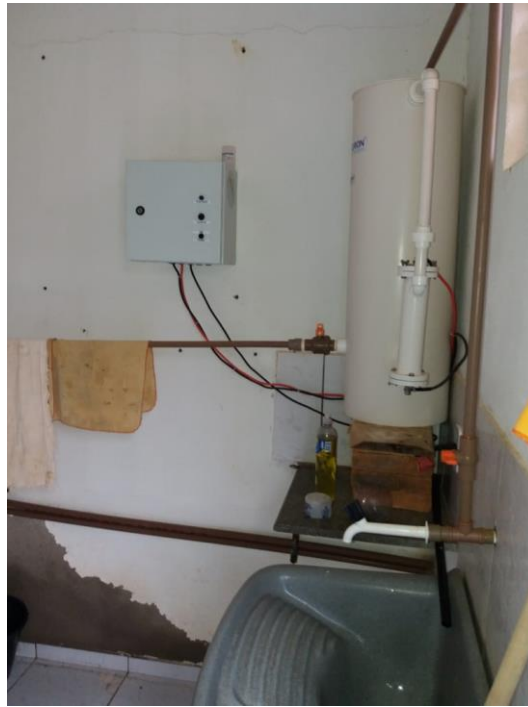
Figura 93 – Painel de controle e máquina de cloro.
