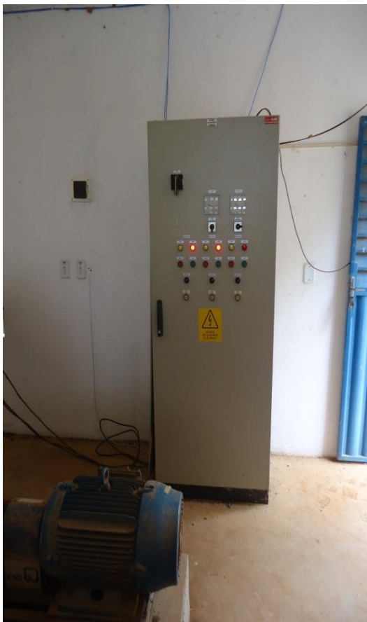
Figura 3 – Painel de Comando.
