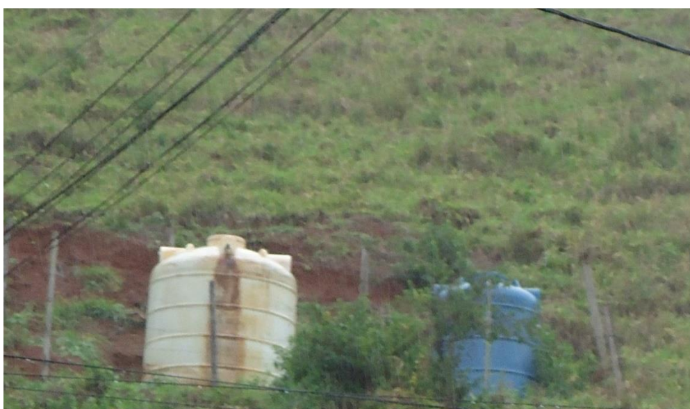
Figura 39 – Reservatórios EEAT do Bairro Otto Luiz Hoffmann.
