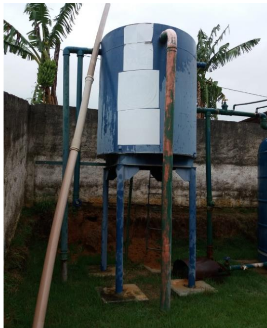
Figura 94 – Unidade de tratamento de água.
