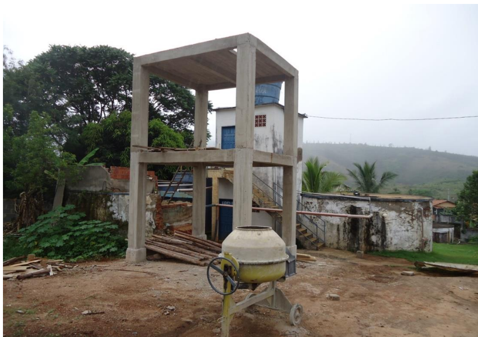
Figura 73 – Entrada da ETA do Distrito Palmeira.
