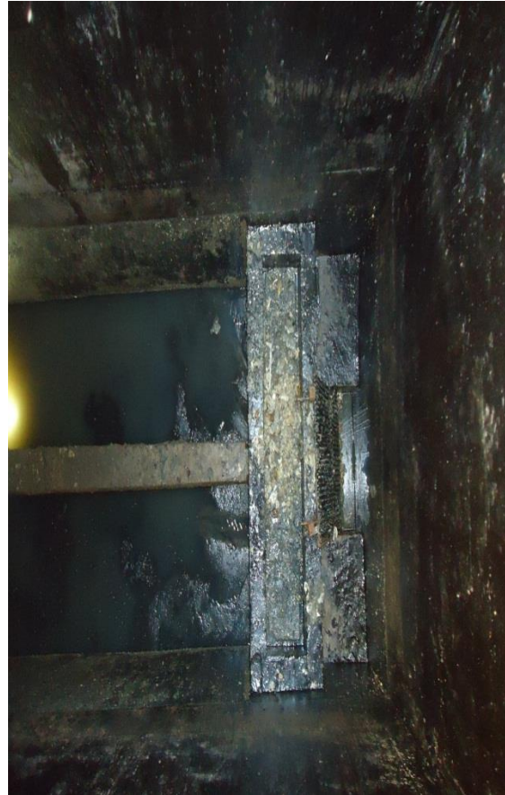
Figura 107 – Caixa de desarenadora.
