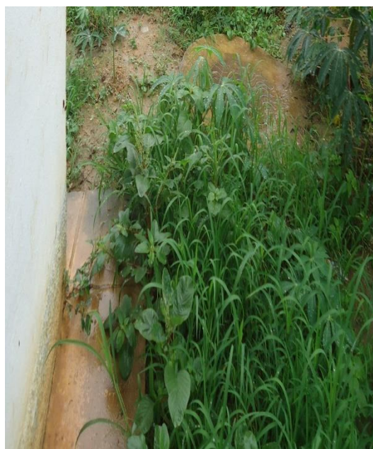
Figura 50 – Excesso de Vegetação EEAT.
