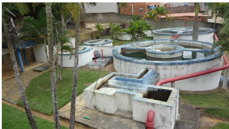
Figura 3.23– Estação de Tratamento de Água de Marilândia.
