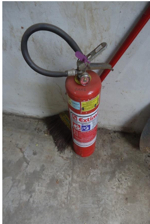
Figura 93 – Extintor de incêndio.
