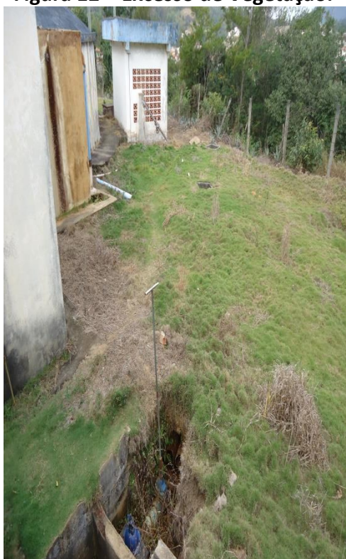
Figura 14 – Excesso de Vegetação.
