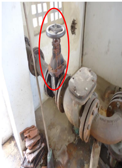
Figura 110 – Vazamento na EEAT.
