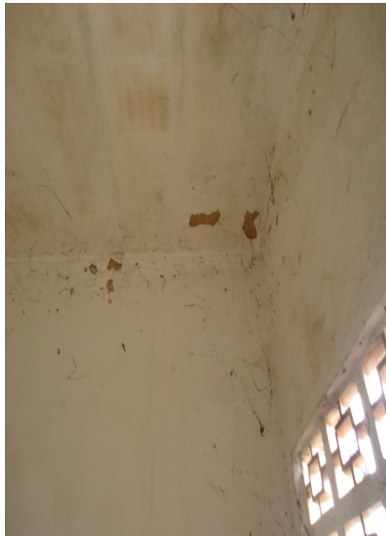
Figura 86 – Paredes da EEAT, necessitando De limpeza.
