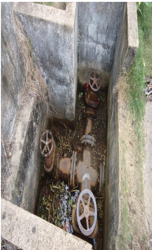
Figura 43 - Registro dos Filtros com vazamento.
