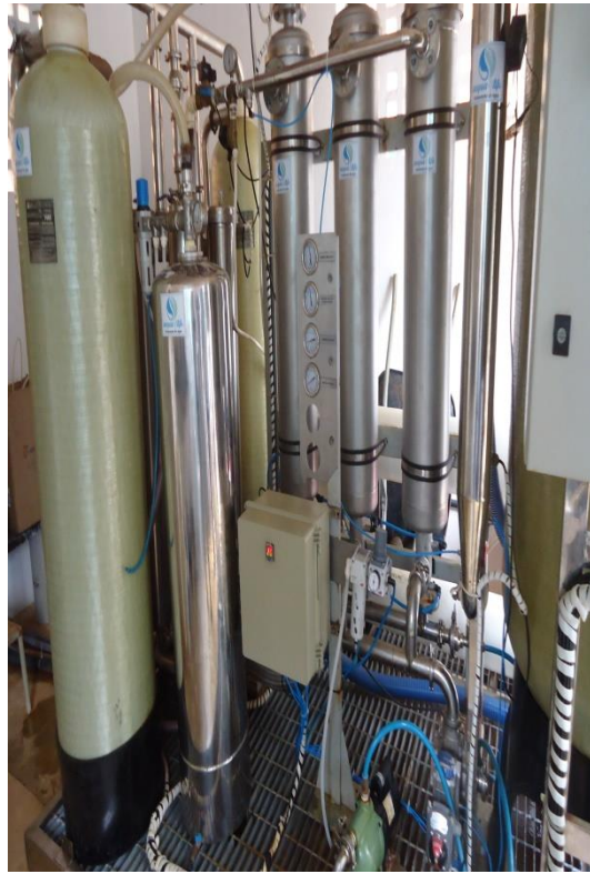
Figura 120 – ETA Compacta Guatemala.
