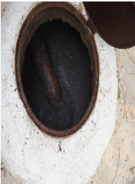
Figura 163 – Chegada do Esgoto Bruto.
