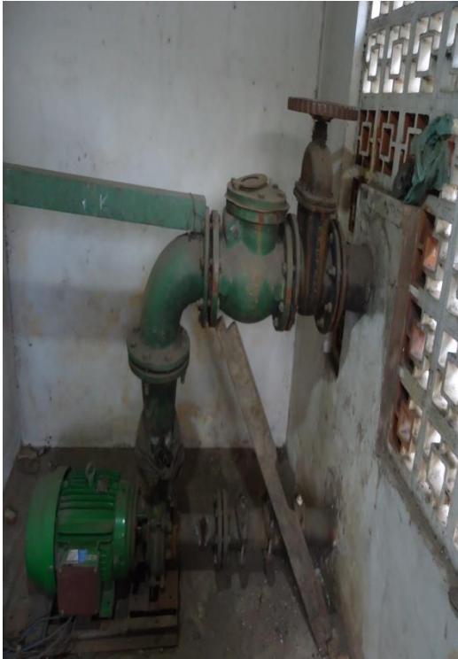
Figura 90- Conjunto Moto Bomba.
