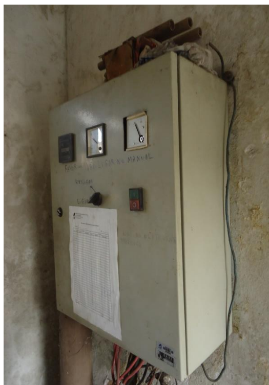
Figura 105- Painele de Controle da EEAT.
