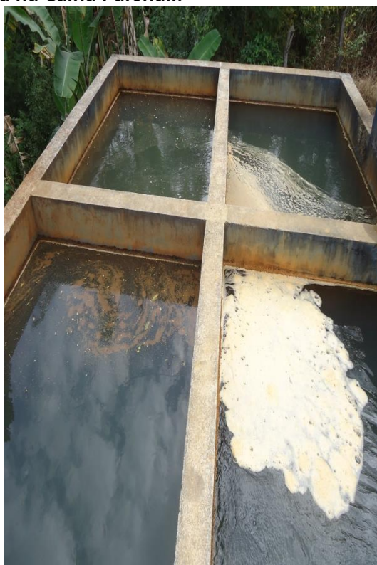
Figura 24 - Floculador sem vazamento.
