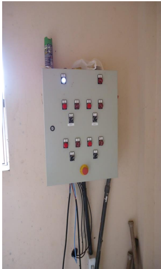
Figura 170 – Painel de Controle.
