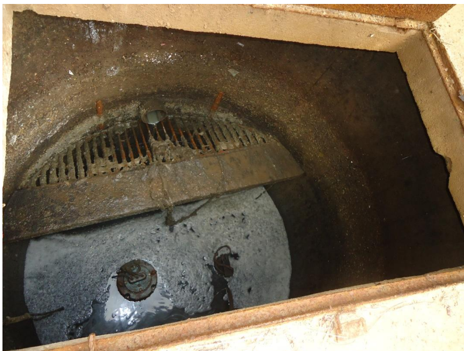
Figura 143 - Poço de Sucção e Grade de retenção.
