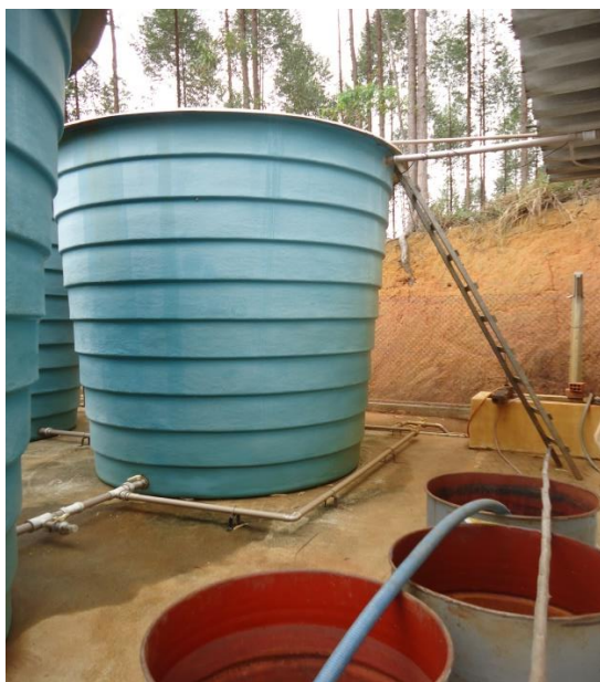
Figura 127– Reservatório da ETA 1.
