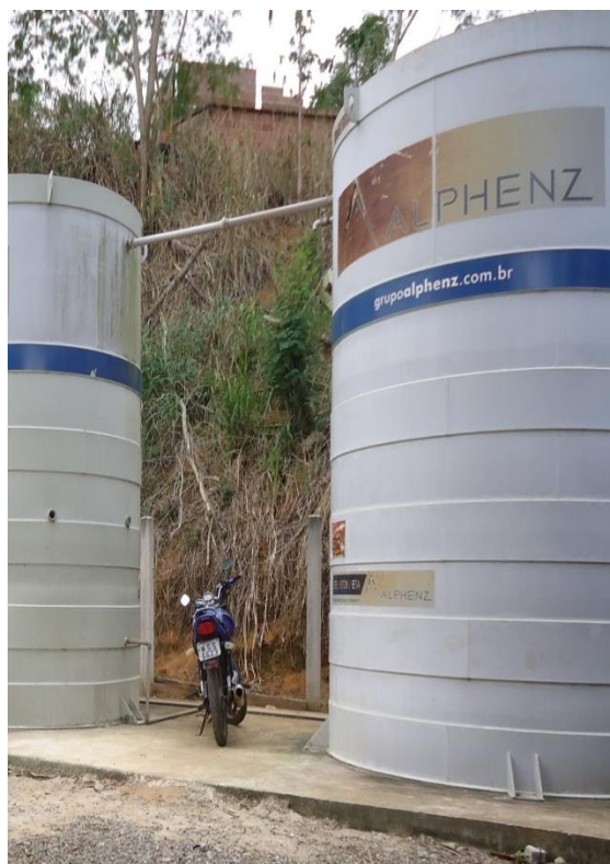
Figura 171 – Tubulação da ETE.
