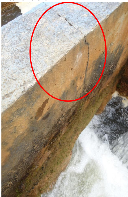
Figura 21 – Fissura na Calha Parshall.
