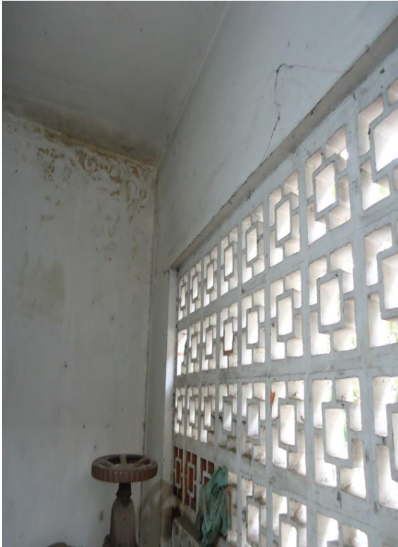
Figura 94– Paredes necessitando de Manutenção de limpeza.
