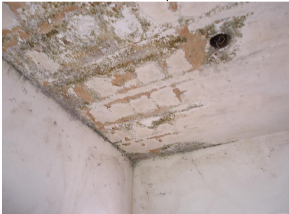
Figura 87 – Laje da EEAT de Francisco, necessitando de manutenção.
