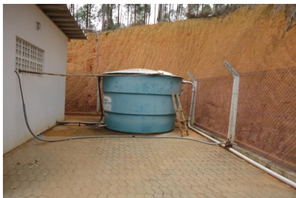
Figura 126 – Unidade de chegada da água Bruta.
