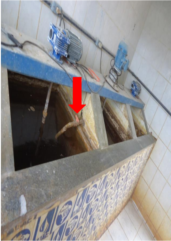
Figura 15 – Tanques de dosagem.
