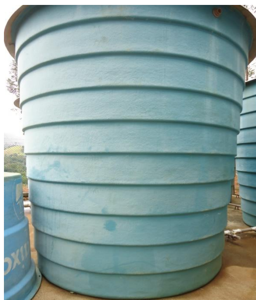
Figura 128– Reservatório da ETA 2.
