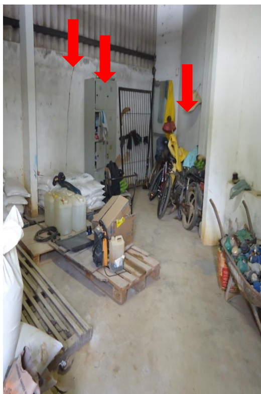
Figura 192 – Armário, EPI's e Fissura.
