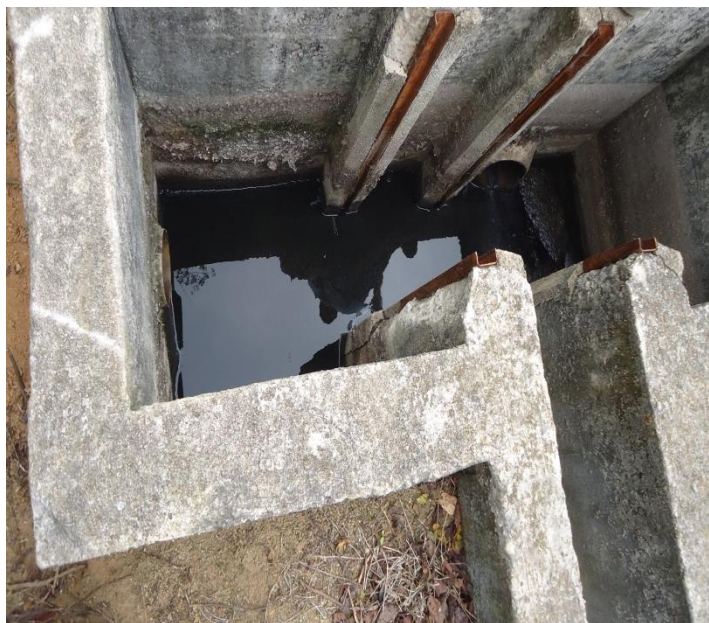
Figura 150 – Chegada do Efluente na ETE.
