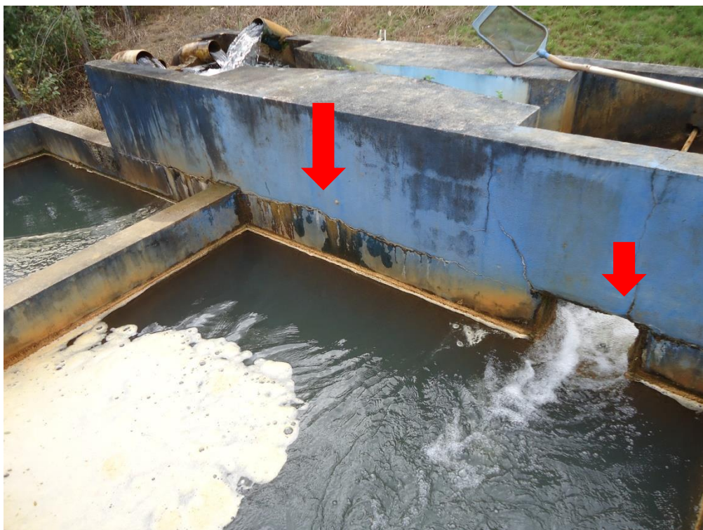
Figura 22 – Fissura na Calha Parshall.
