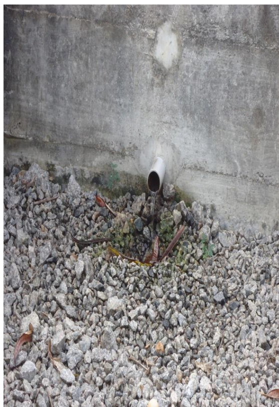
Figura 173 – Efluente Pronto para lançamento final.
