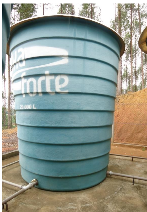
Figura 130– Reservatório da ETA 4.
