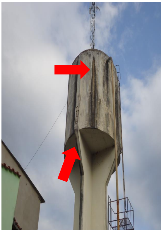
Figura 102- Ferragem exposta e fissura com vazamento.
