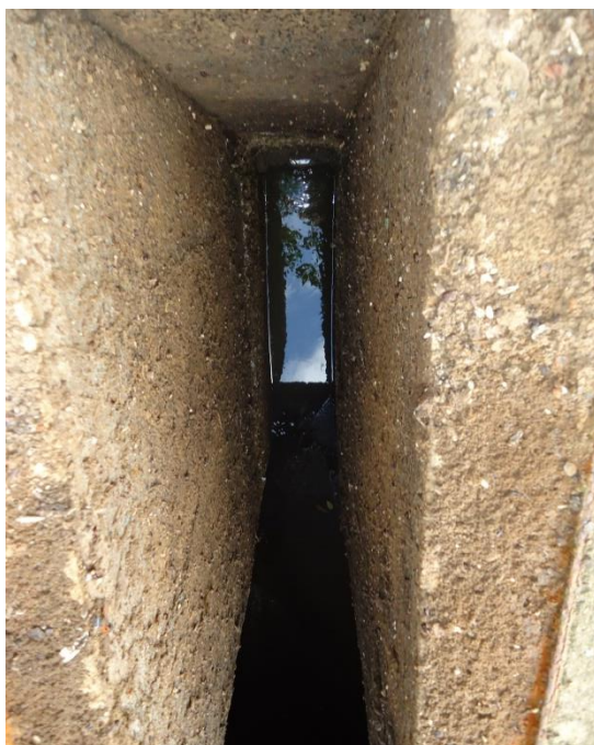
Figura 141 – Entrada do Efluente.
