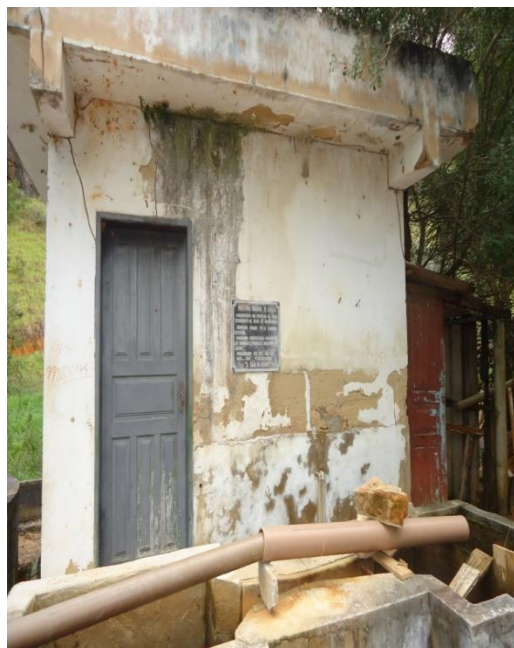
Figura 136 – Casa de Bomba desativada.
