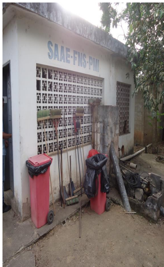
Figura 89 – Casa de bomba EEAT.
