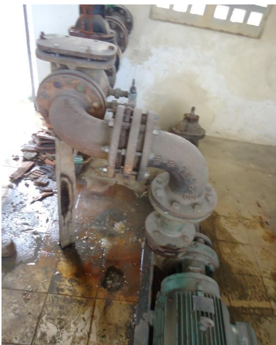
Figura 109 – Conjunto moto-bomba com Vazamento.
