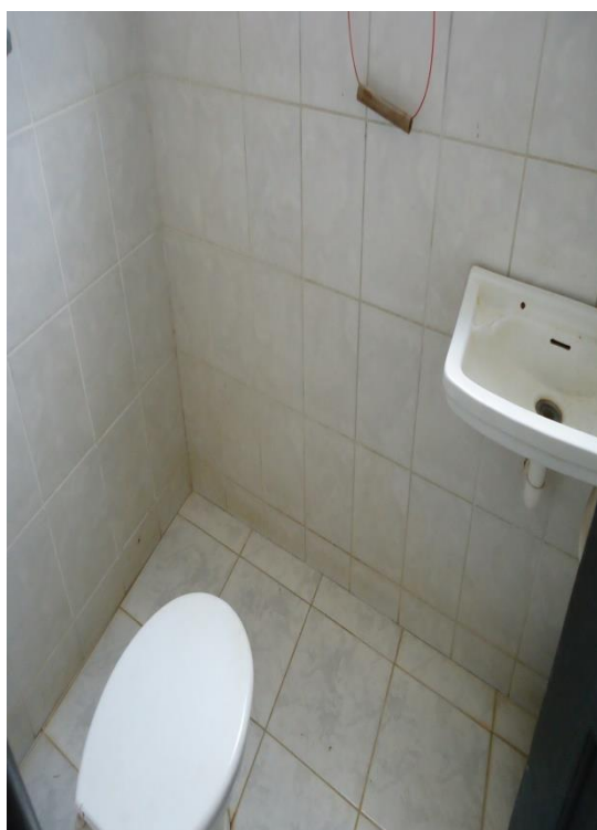
Figura 72 – Banheiro ETA da Sede 2.
