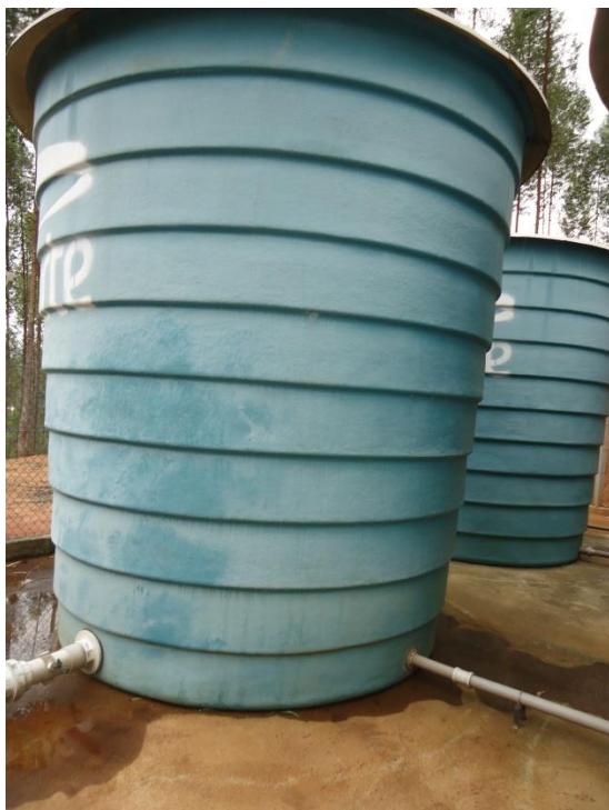
Figura 129– Reservatório da ETA 3.
