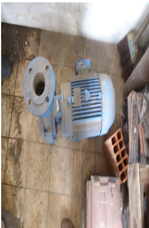
Figura 107– Bomba Reserva na EEAT.
