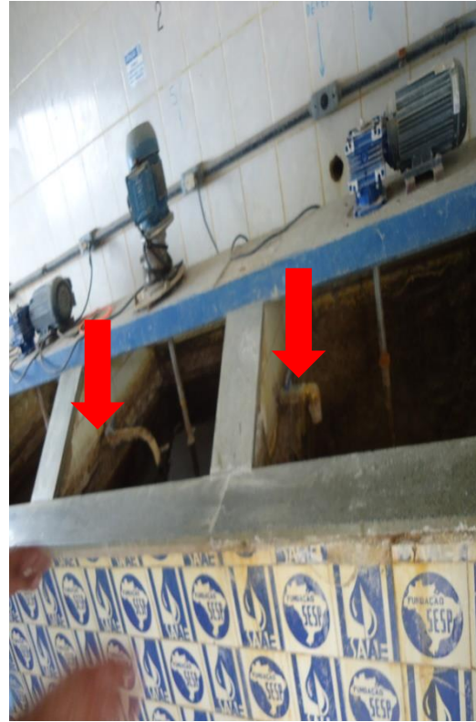
Figura 16 – Tranques de dosagem, necessitam de manutenção interna.
