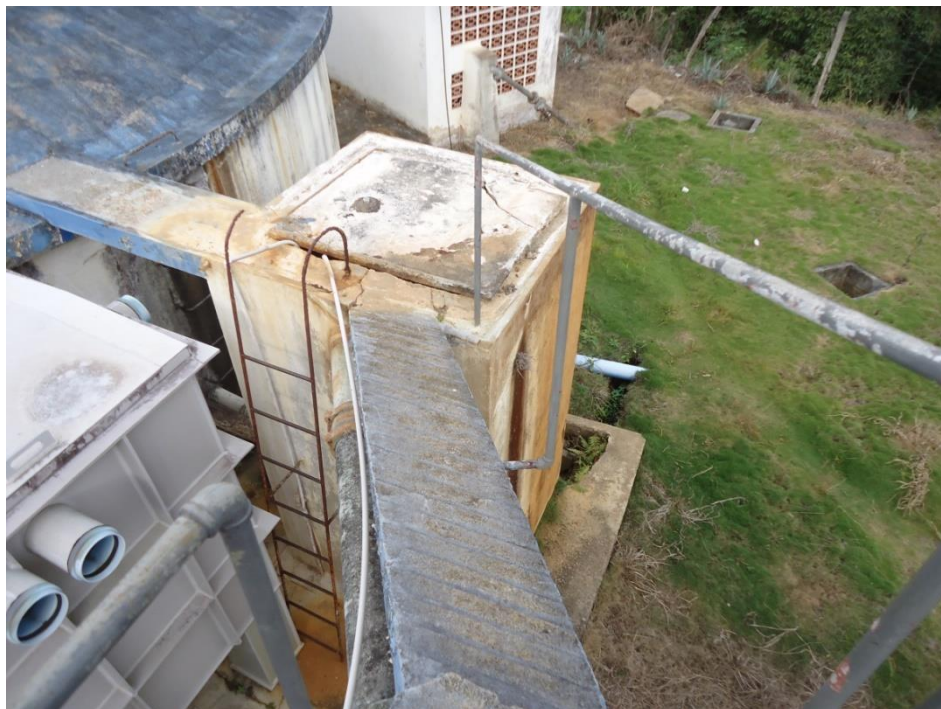
Figura 42 – Passarela de acesso aos filtros necessitando de manutenção.
