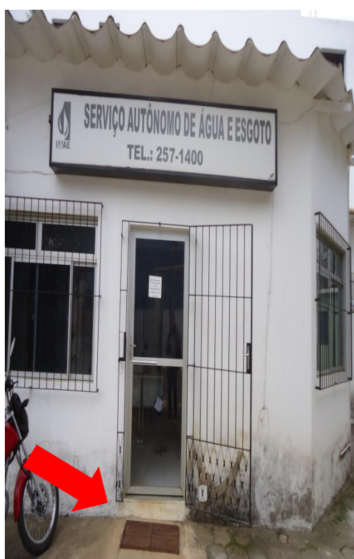
Figura 175 – Falta de acessibilidade.
