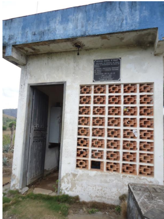
Figura 80 – Casa de bomba EEAT Francisco Campagnaro.
