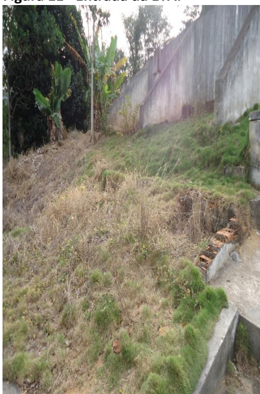
Figura 13 – Excesso de Vegetação na ETA.
