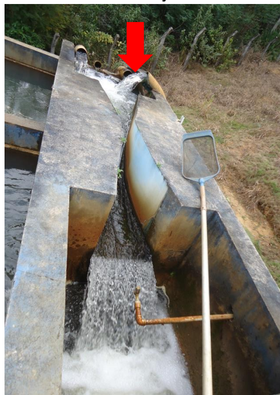
Figura 18 – Chegada da Água Bruta na ETA.
