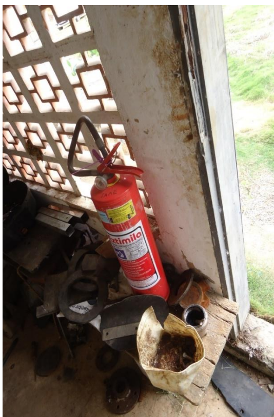
Figura 83 – Extintor de Incêndio EEAT.
