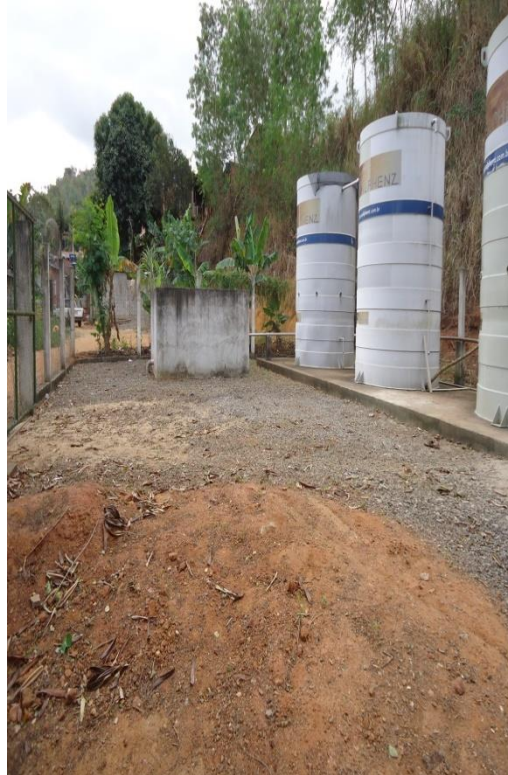
Figura 159- Pátio ETE Guatemala.
