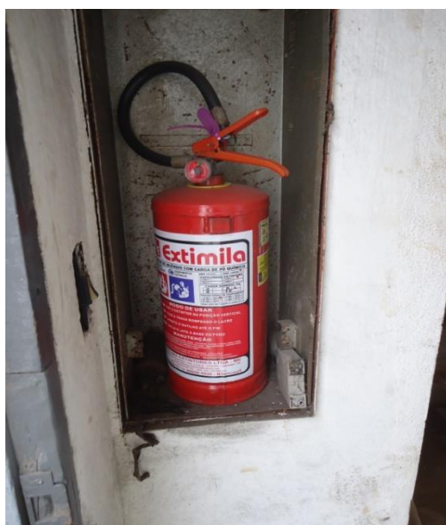
Figura 106- Extintor de incêndio.
