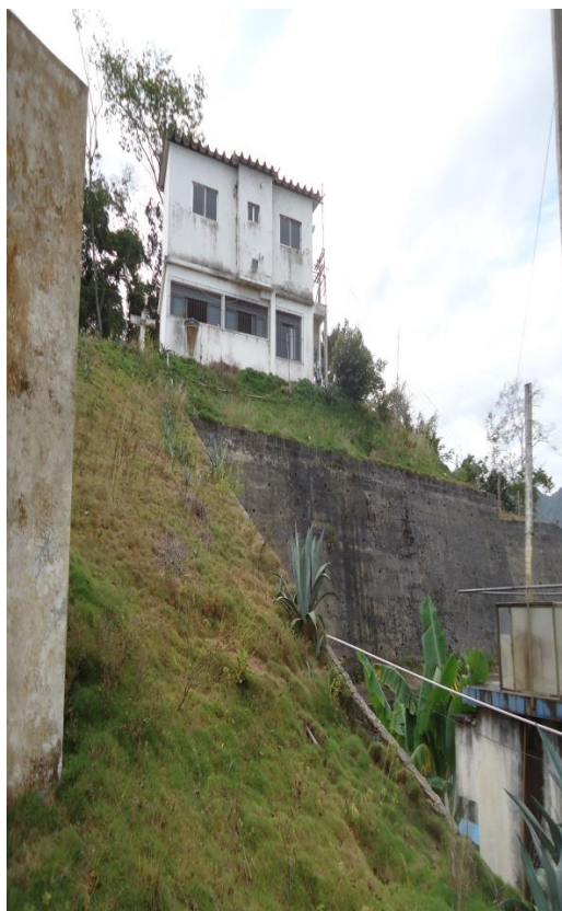
Figura 12 – Excesso de Vegetação.
