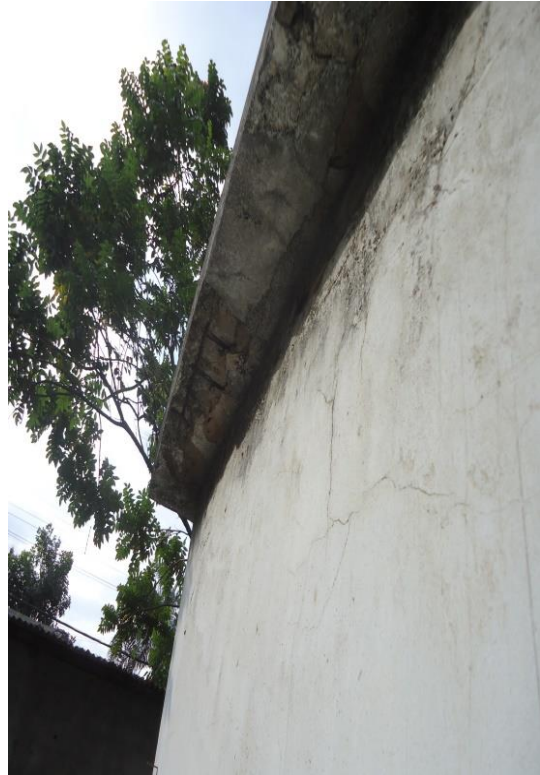
Figura 95 – Ferragem exposta na casa EEAT.
