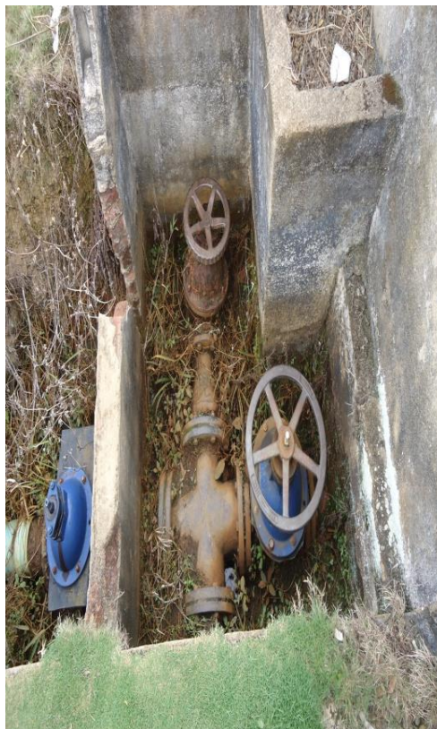
Figura 44- Registro dos filtros sem vazamento.
