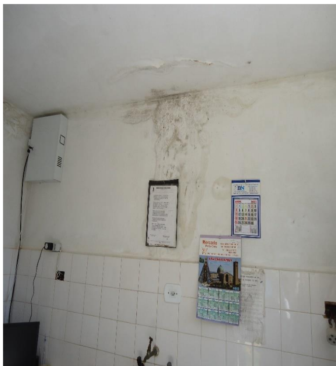
Figura 73 – Fissura com vazamento e infiltração do Teto do Laboratório.
