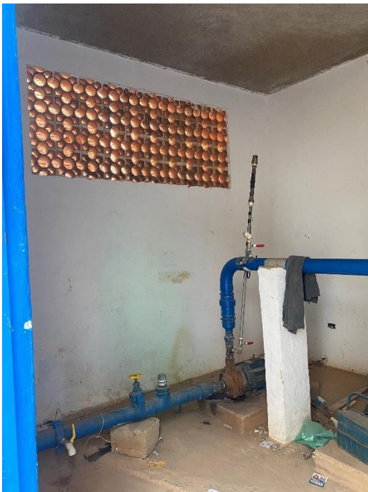
Figura 142 -Conjunto Moto Bomba.
