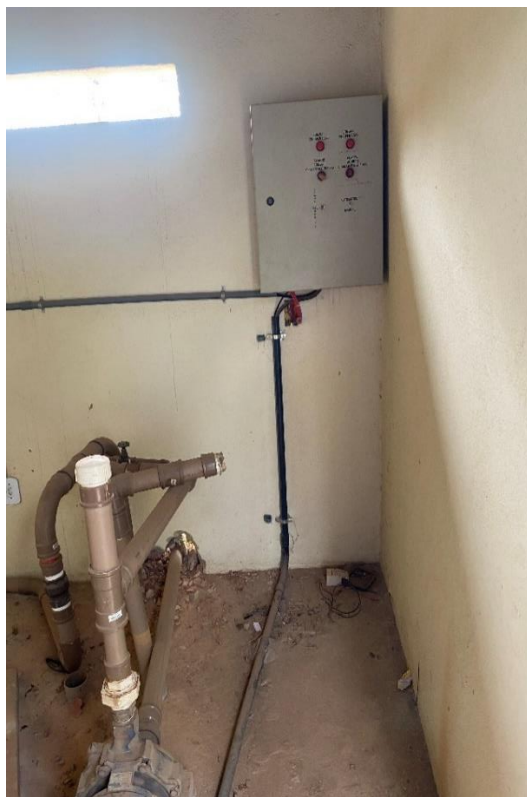
Figura 114 - Painel de Controle da EEAT.
