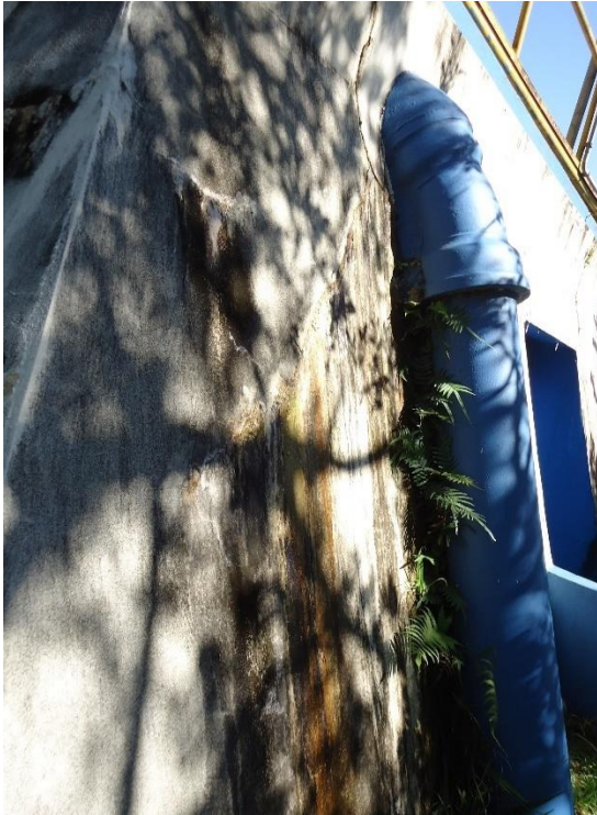
Figura 41- Fissura na estrutura do Decantador 2.
