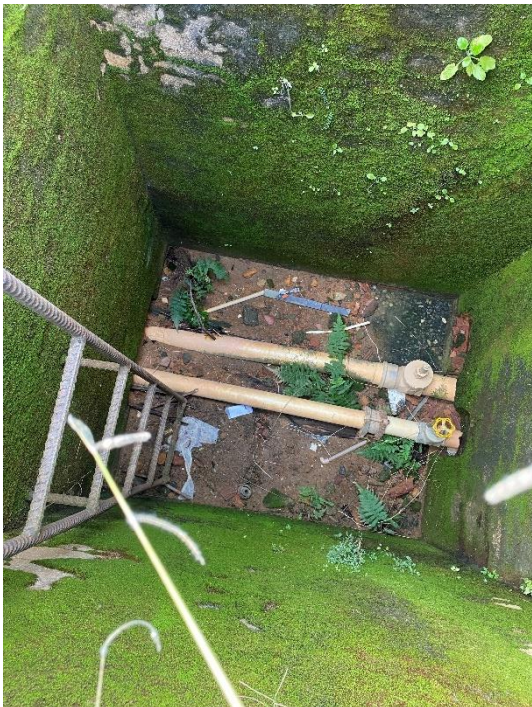
Figura 149 – Excesso de Vegetação nos Registro.
