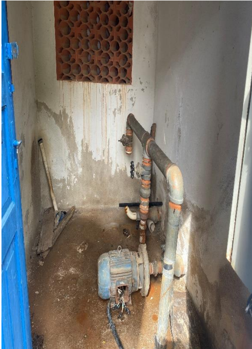
Figura 131 – Objetos indesejáveis e paredes Internas que necessitam de manutenção de pintura.
