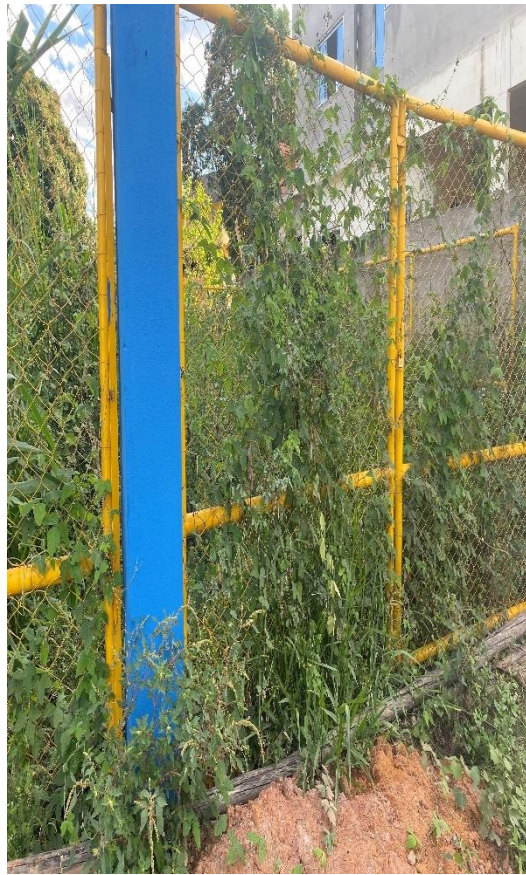
Figura 221 - Excesso de Vegetação EEEB.
