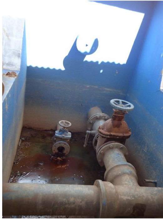
Figura 47– Registro 3 com Vazamento.
