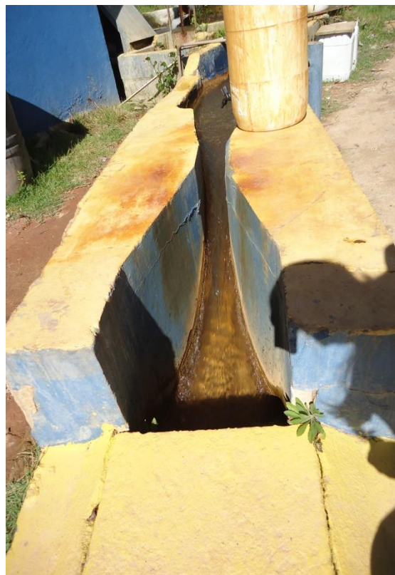
Figura 25 – Calha parshall ETA Cristo 2.
