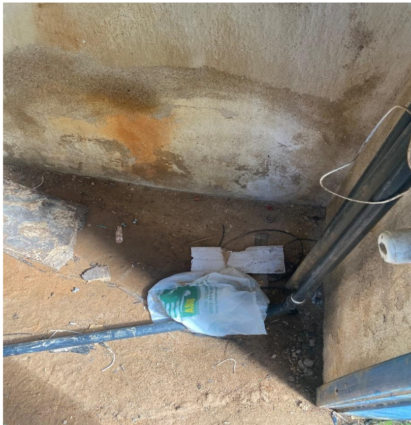
Figura 131 – Objetos indesejáveis, necessitando de manutenção de limpeza.
