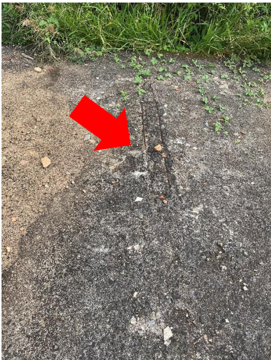
Figura 153 – há ferragem exposta no Reservatório.
