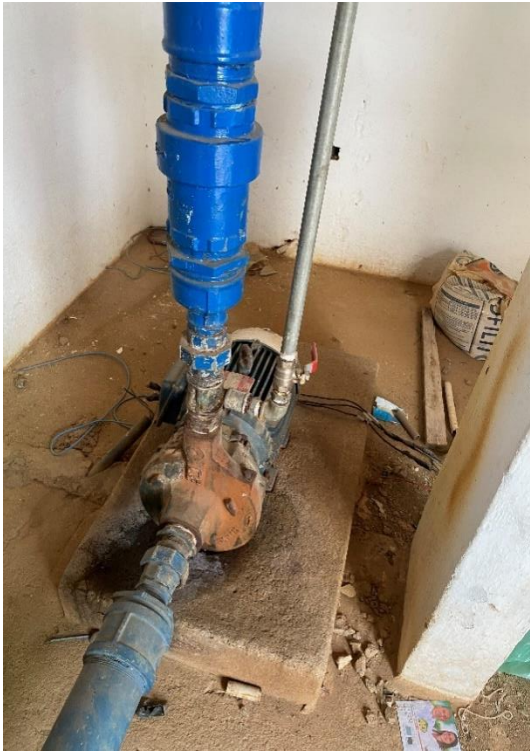
Figura 140 - Conjunto Moto Bomba da EEAT.
