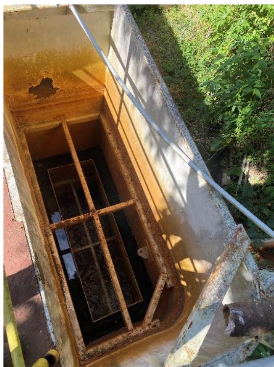
Figura 104 – Estrutura da ETA desativa, precisando de manutenção de limpeza tendo em vista presença de água na estrutura.
