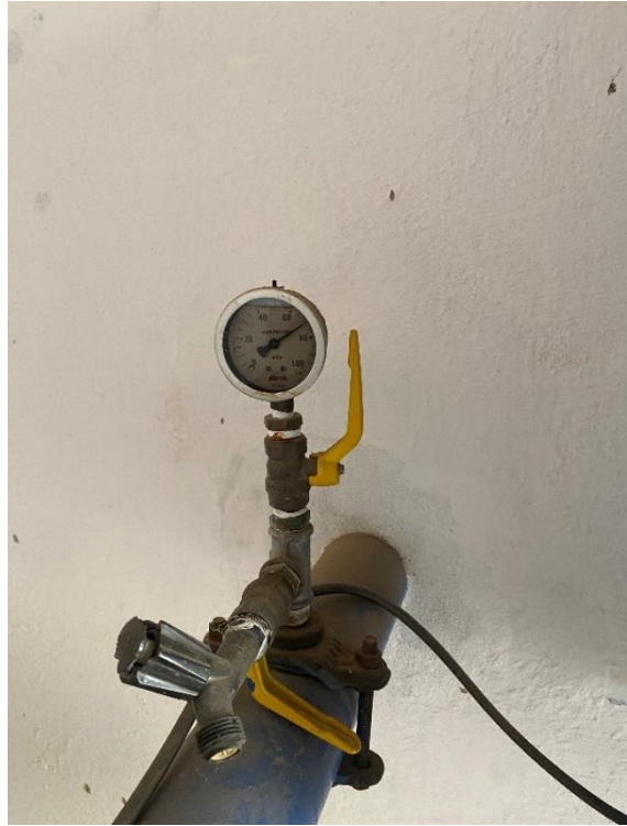
Figura 141 - Medidor do Conjunto Moto Bomba.
