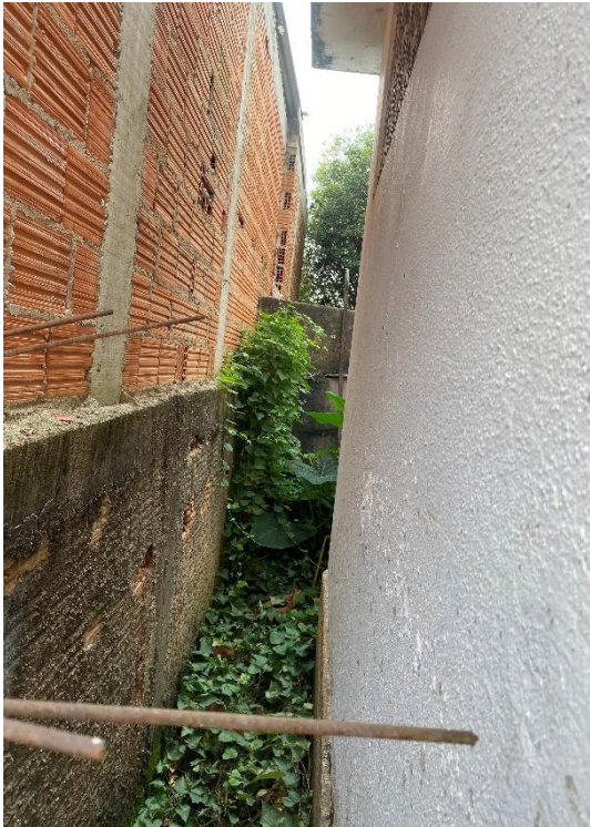
Figura 143 – Excesso de Vegetação da EEAT.
