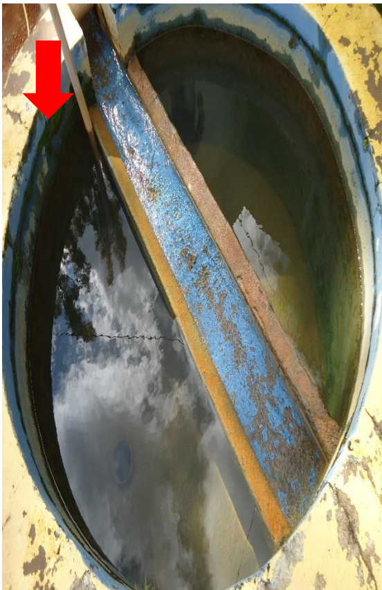
Figura 172 – Filtro da ETA.
