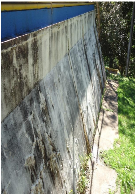
Figura 39 – Estrutura do Decantador.
