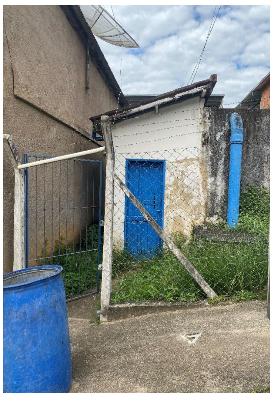
Figura 123 – Casa de bomba EEAT Vila dos Professores.
