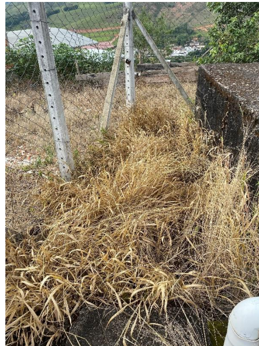
Figura 150 – Excesso de Vegetação no entorno.
