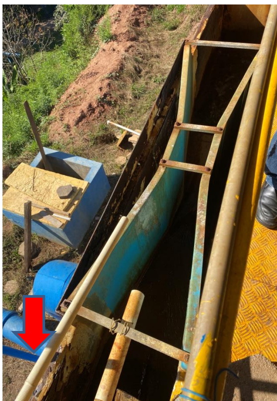
Figura 24 – Calha parshall ETA Cristo Compacta 1.
