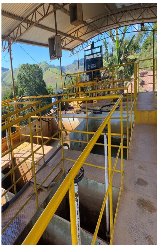
Figura 10 –ETA Sede Compacta 1.
