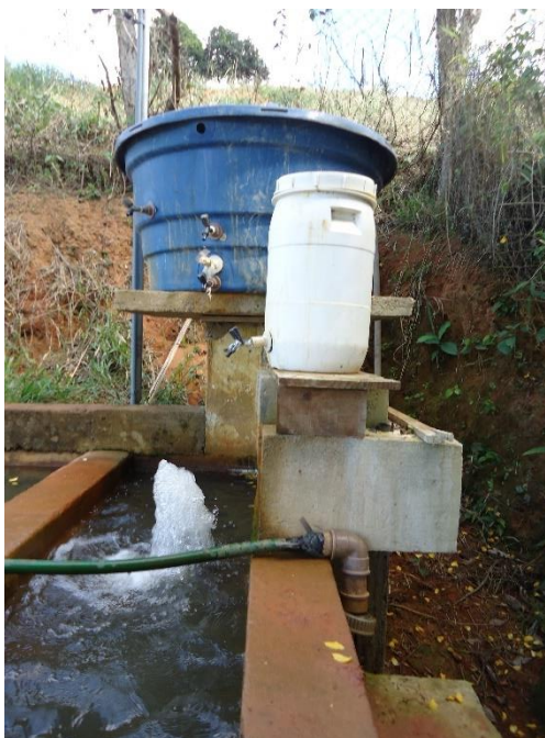
Figura 194- Dosadores de cloro e sulfato.
