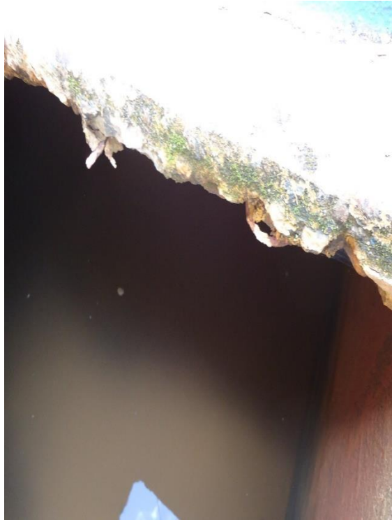
Figura 179 – Tampa do Reservatório com Ferragem exposta.
