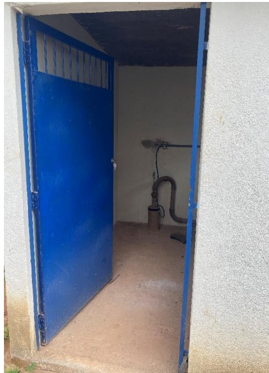
Figura 112 – Entrada EEAT Manoel Monteiro.
