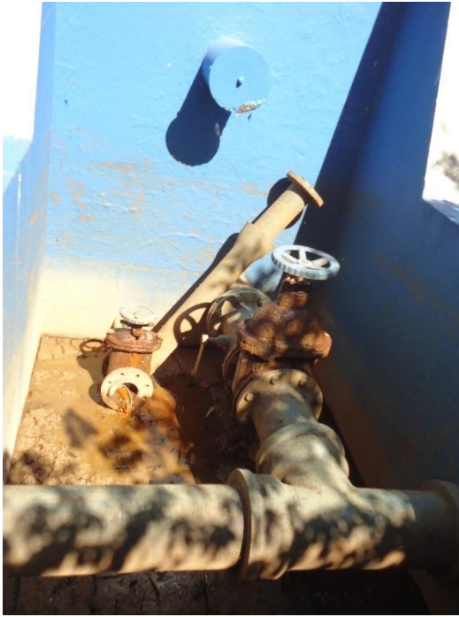
Figura 46– Registro 2 com Vazamento.
