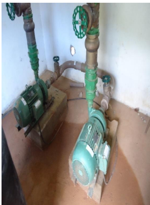
Figura 156 – Conjunto Moto Bomba.
