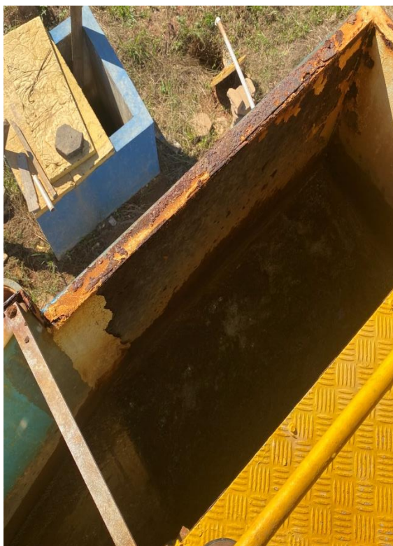
Figura 20- Chegada da água Bruta ETA Cristo Compacta 1.
