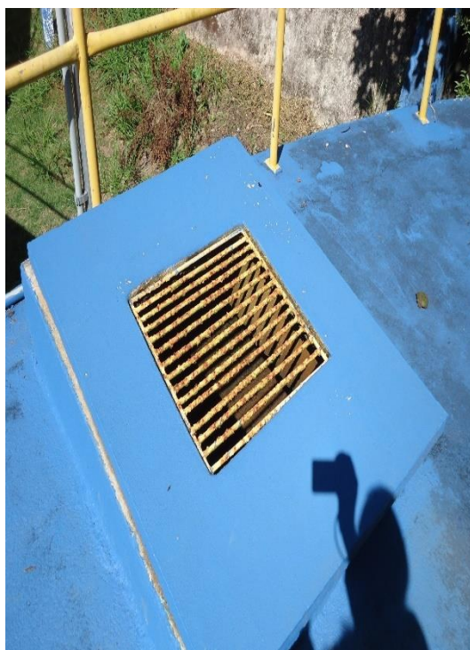
Figura 87 – Tampa do Reservatório 1
