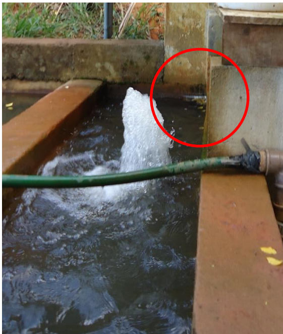
Figura 196 –Entrada da Água Bruta.
