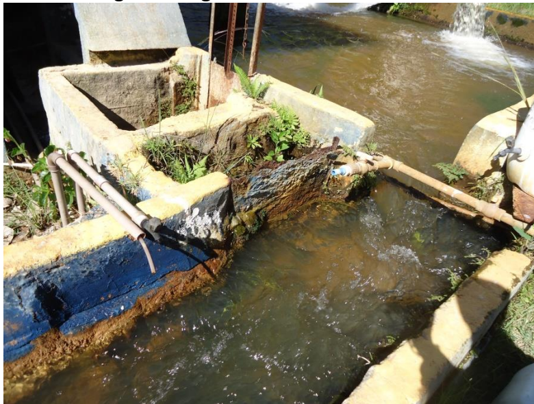
Figura 24 – Estrutura de Chegada da água Bruta da ETA Cristo 2.
