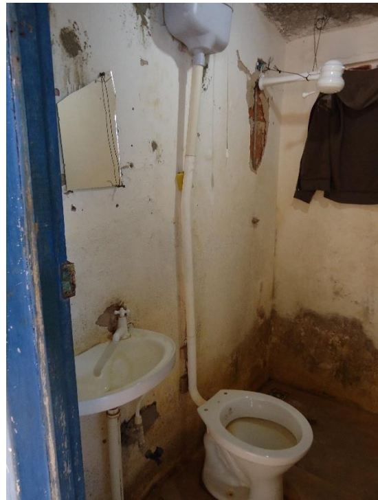
Figura 203- Banheiro da ETA.
