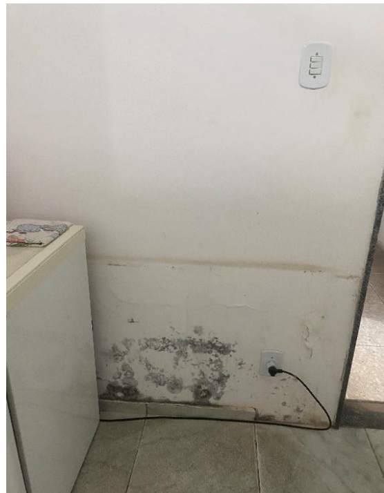
Figura 229- Infiltração nas instalações.
