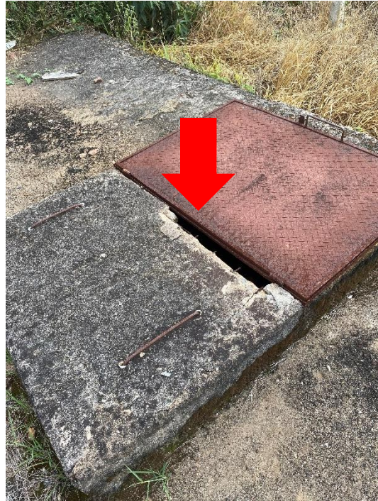
Figura 152 – Tampa do reservatório.
