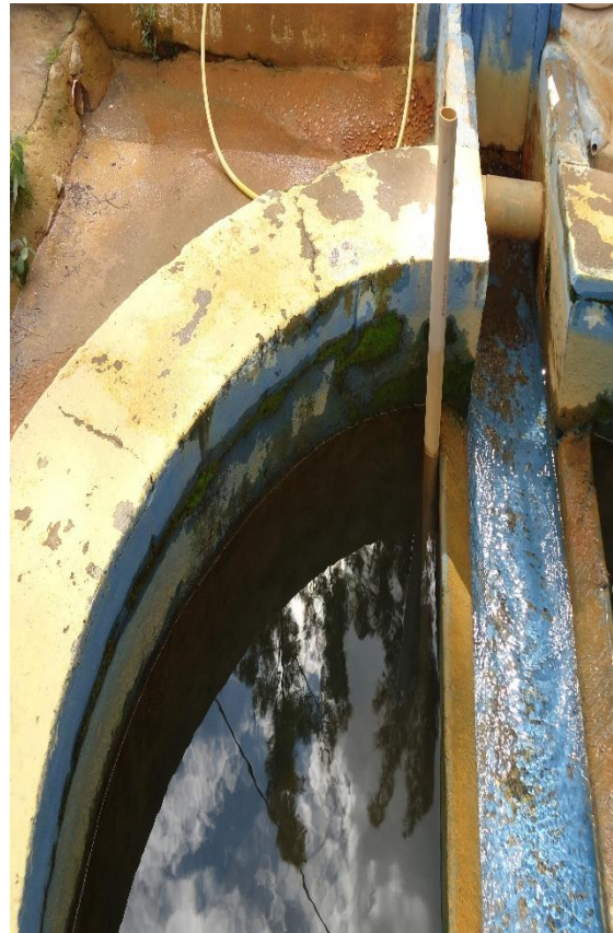
Figura 173- Descarga dos filtros.
