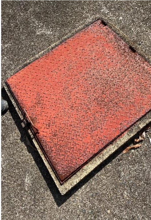
Figura 105– Tampa do Reservatório precisando de manutenção de limpeza.
