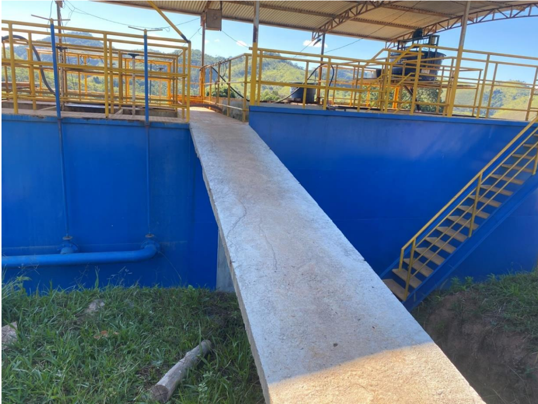
Figura 70 – Rampa de Acesso a ETA Cristo Compacta 1 sem guarda corpo.
