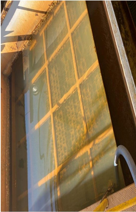
Figura 33 –Decantador ETA Compacta 1
