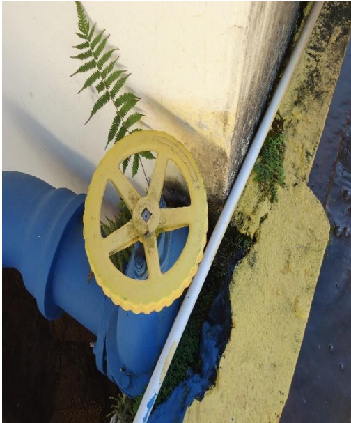
Figura 50 - Excesso de Vegetação no Registro.
