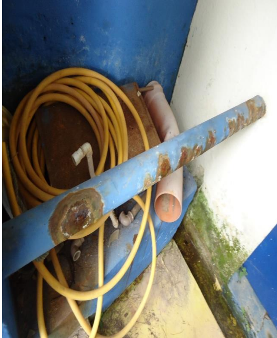
Figura 180 - Tubulação com Corrosão.
