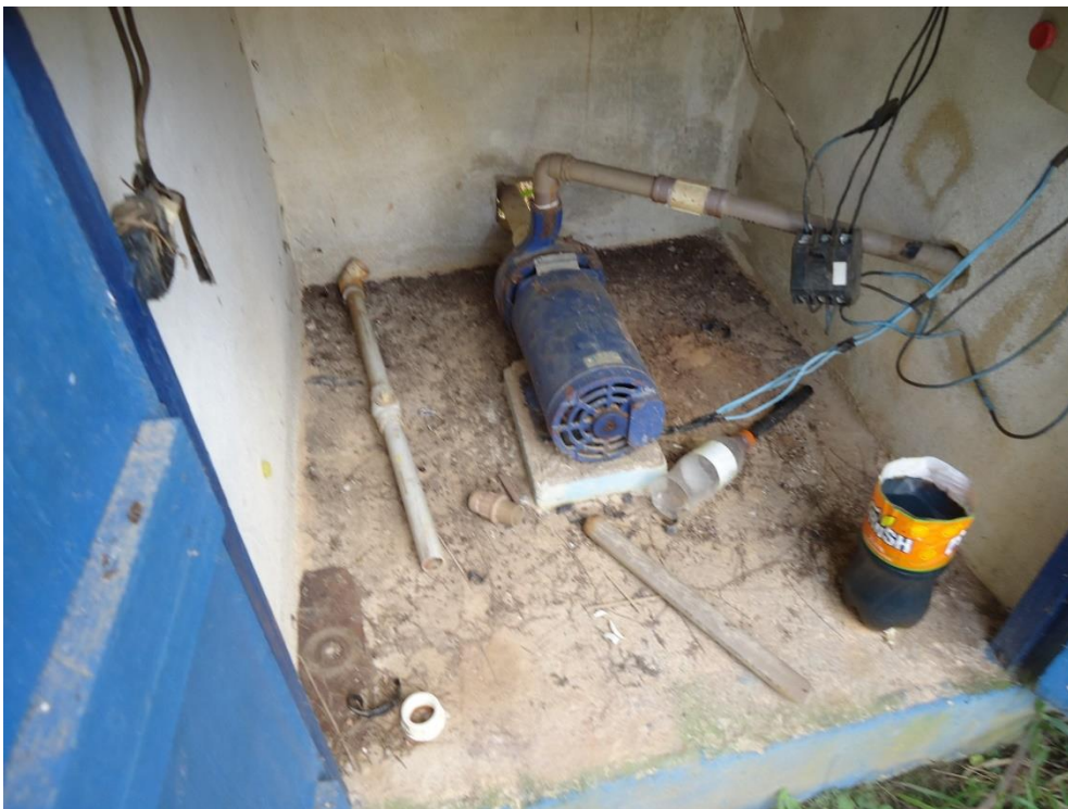
Figura 185- Conjunto moto-bomba do poço.
