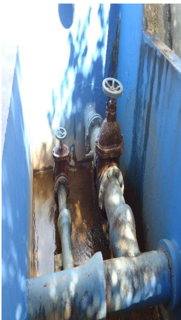
Figura 43– Registro 1 com vazamento.
