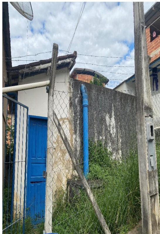
Figura 124 – Casa de bomba EEAT Vila dos Professores.
