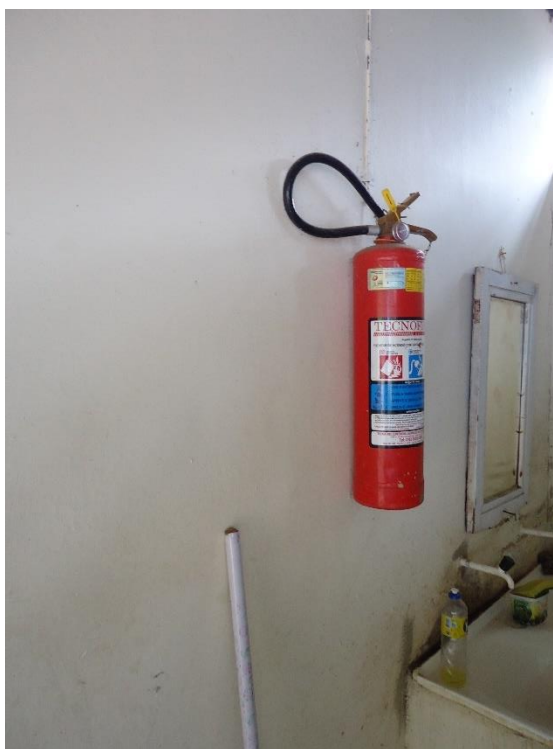
Figura 192- Extintor de incêndio.
