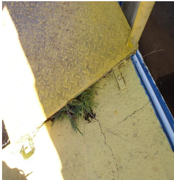
Figura 51 - Excesso de vegetação na rampa.
