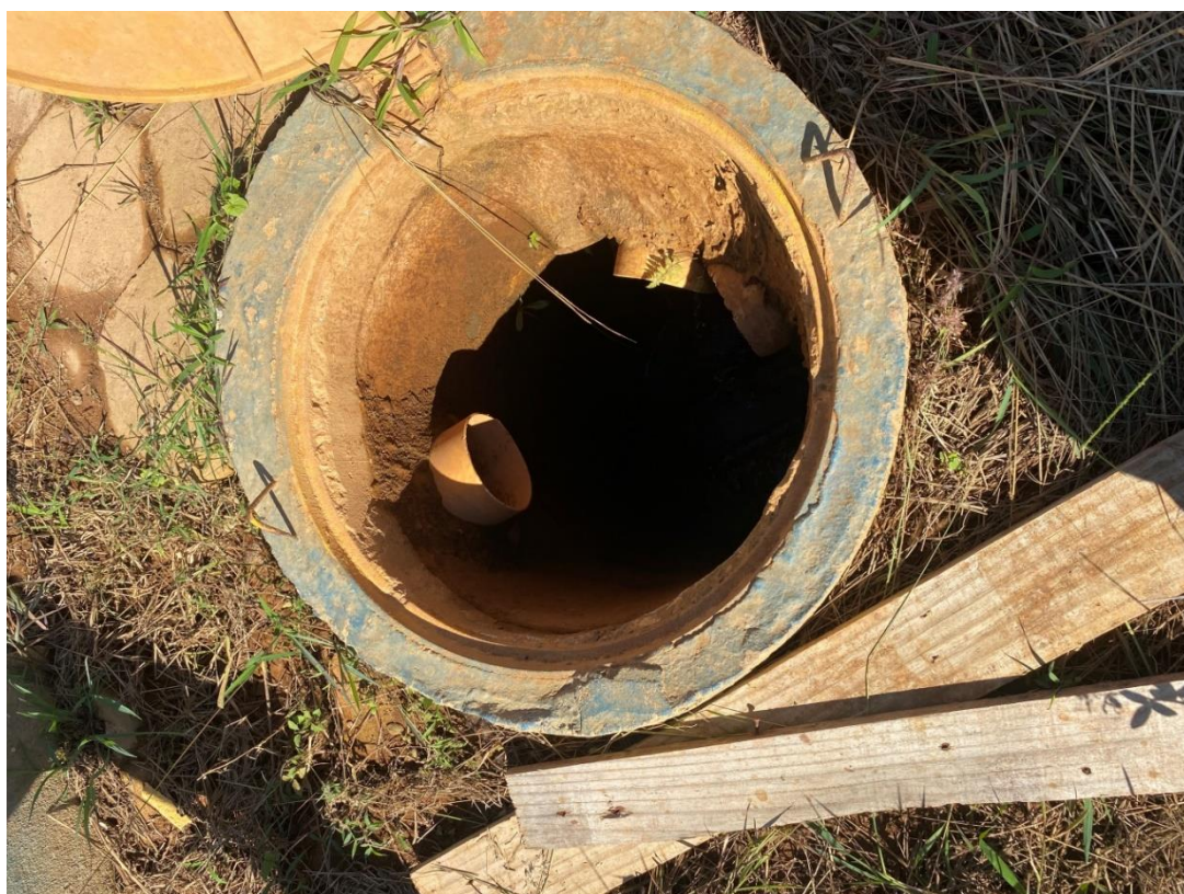
Figura 69 – Descarga dos filtros.
