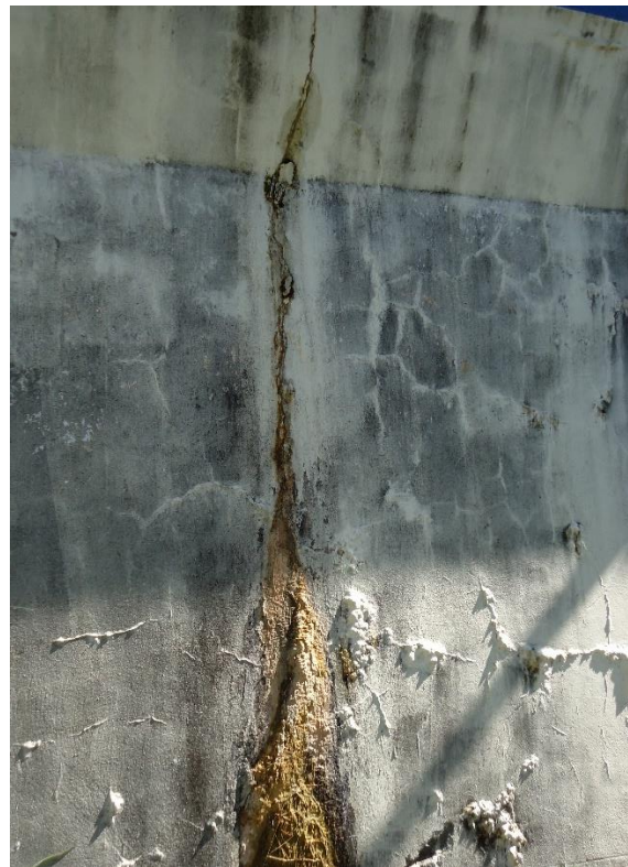
Figura 40- Fissura na estrutura do Decantador 2.
