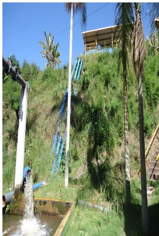
Figura 21 – Chegada da água bruta ETA Cristo 2.
