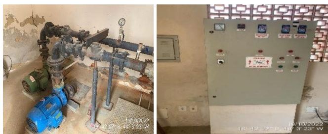
Figura 65 – Conjunto Moto Bomba, Pannel de Controle.
