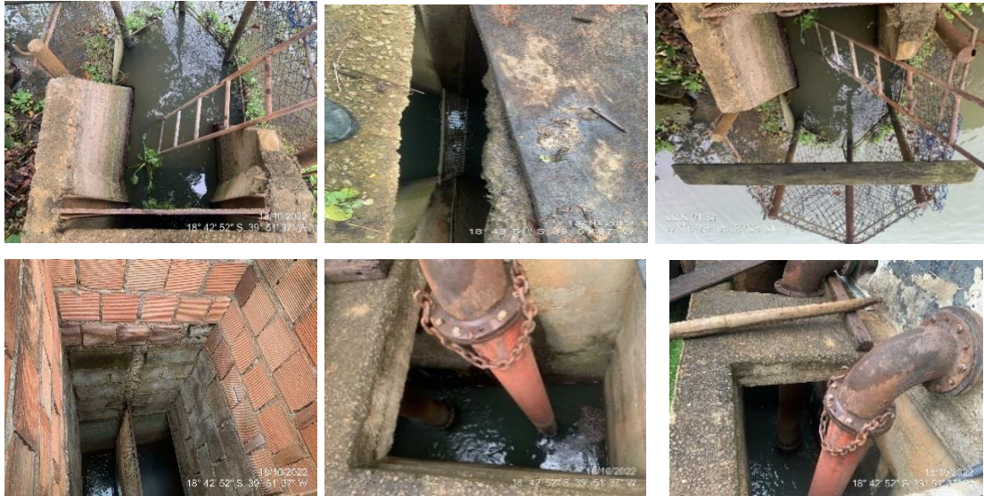
Figura 3 – Captação do Rio Cricaré.
