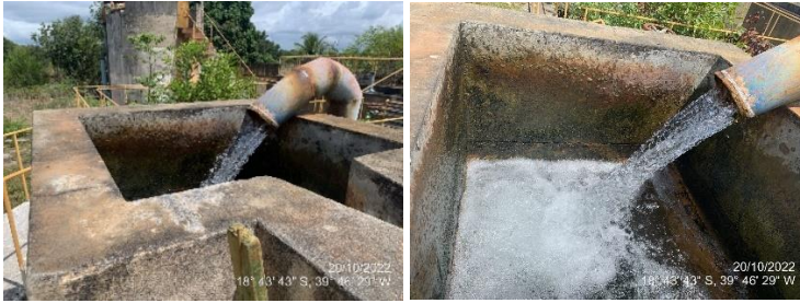
Figura 110 – Estrutura de chegada da água bruta.
