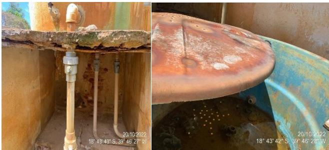
Figura 108 – Laje de apoio ao dosador e Dosador desativado.
