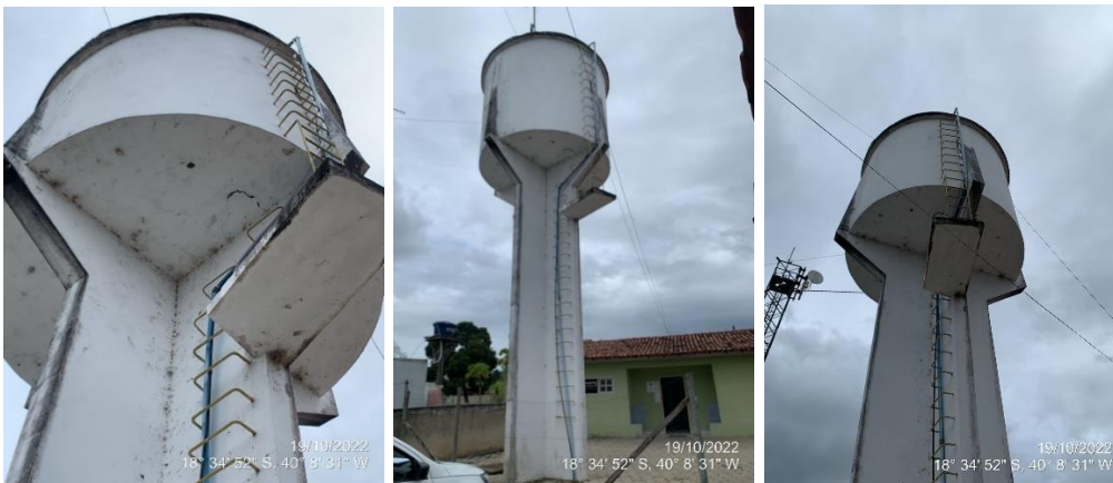
Figura 100 – Reservatório de Ferragem exposta.
