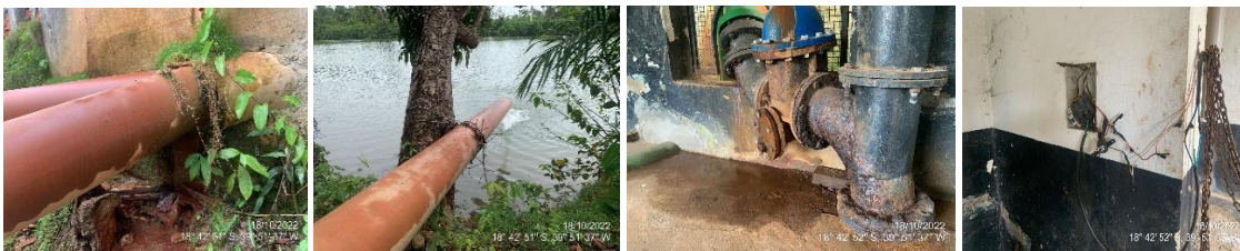
Figura 8 – Vazamento da Rede de descarga, no Registro e Fiação exposta
