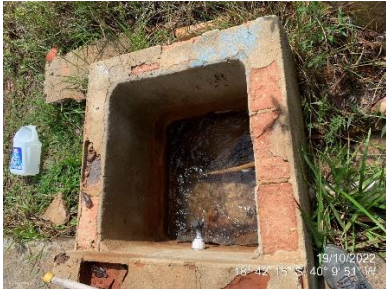
Figura 71 - Chegada da água bruta
