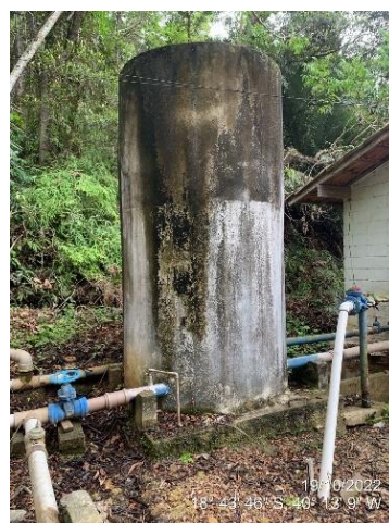
Figura 83 – Reservatório do KM 41
