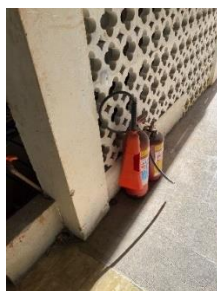
Figura 46 - Extintor de incêndio
