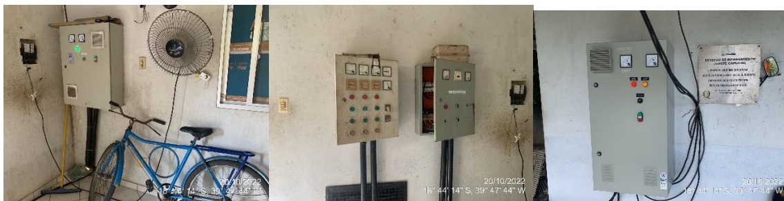
Figura 138 – Paineis de Controle Rio Preto.
