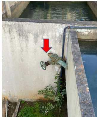
Figura 28 – Tubulação com Vazamento.
