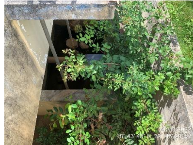
Figura 118.1 – Excesso de vegetação registros.
