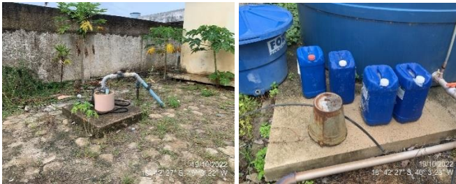
Figura 68 – Poço de Captação
