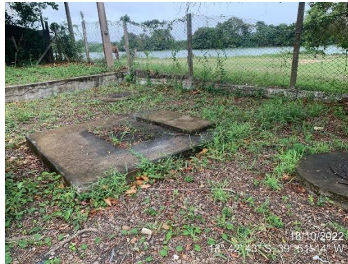
Figura 145 - Poço de sucção.
