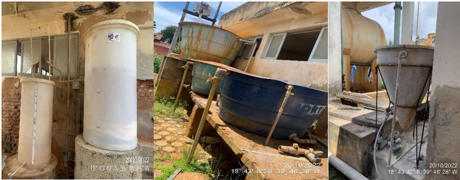
Figura 107 – Dosadores de Cloro, Cloro e Flúor.
