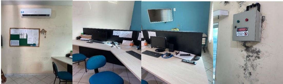
Figura 51 - Sala de Coordenação da ETA
