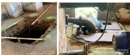
Figura 134 – Reservatório da EEAB Guriri.
