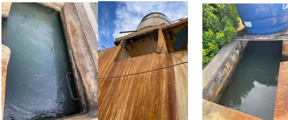
Figura 21 – Chegada da água Bruta 1 e 2.
