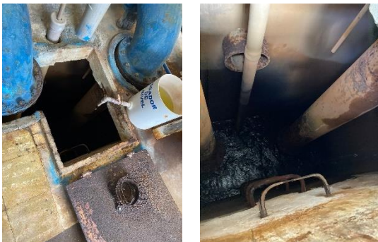
Figura 62- Reservatório submerso ETA São Mateus.
