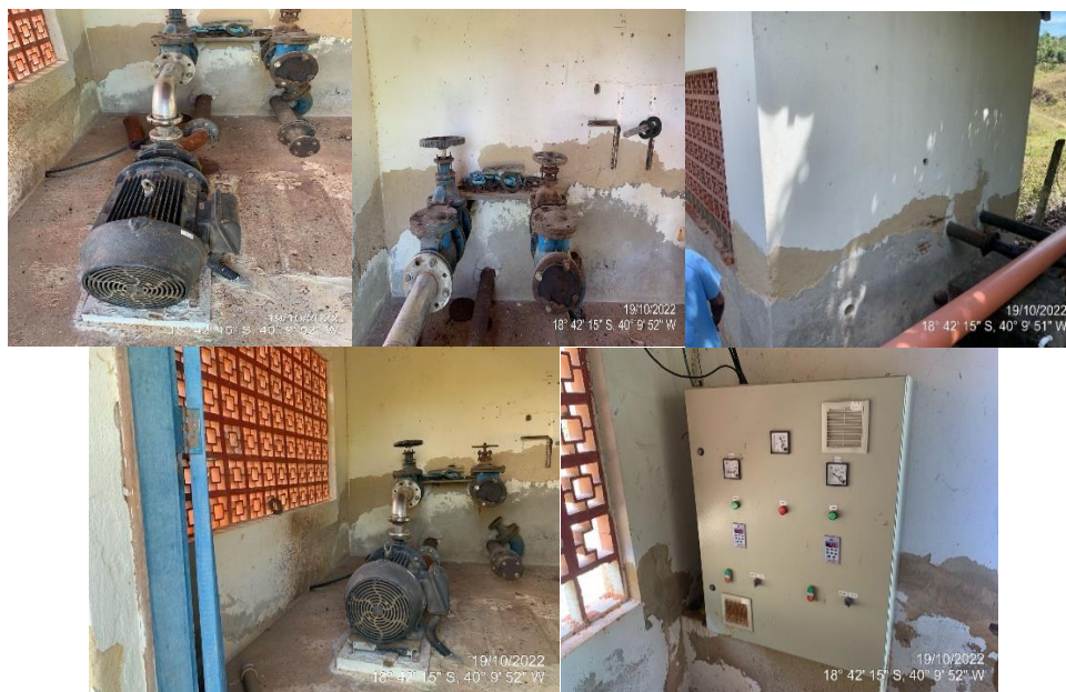
Figura 78 - EEAT do KM 35
