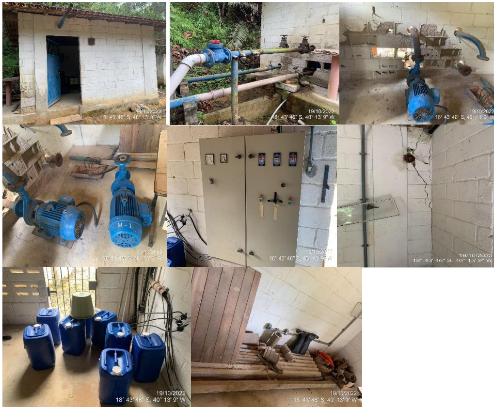
Figura 82 - EEAT do KM 41
