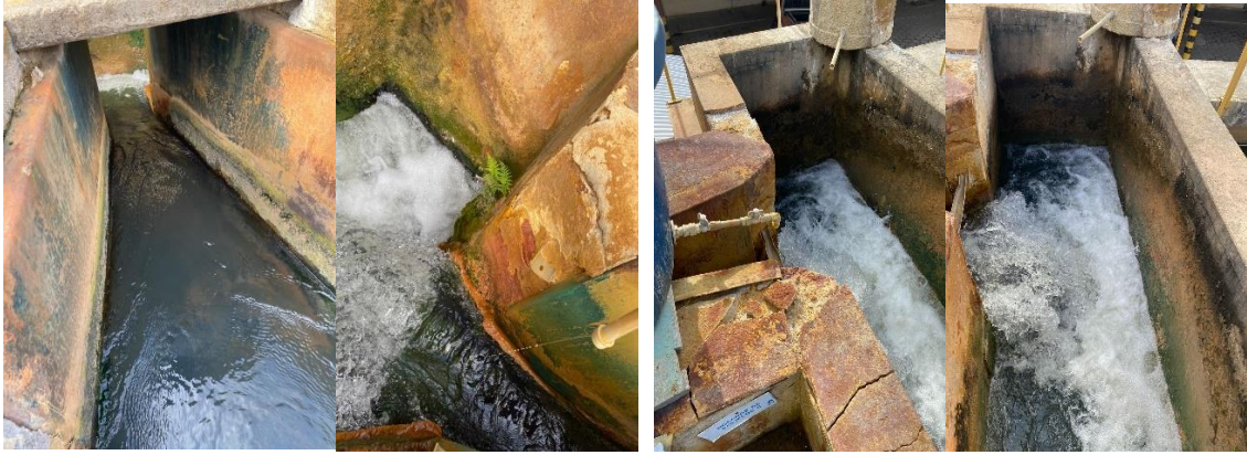
Figura 22 – Calha parshall 1 e 2.
