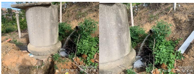
Figura 185- Chegada esgoto bruto.
