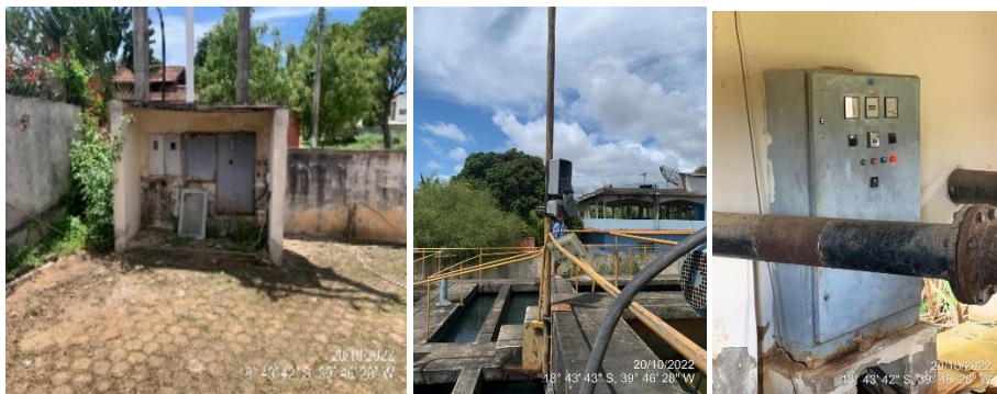
Figura 125 – Painel de controle de controle 1, 2, 3 e 4.
