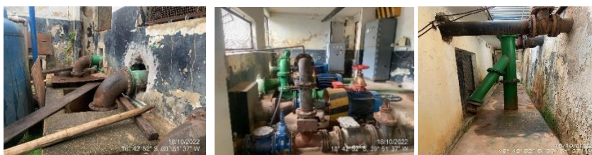
Figura 4 – Conjunto Moto bomba.
