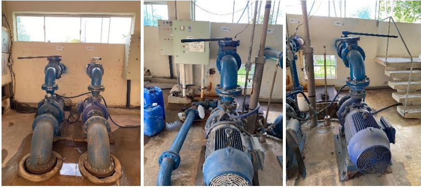
Figura 60- Conjunto Moto Bomba EEAT da ETA sede.
