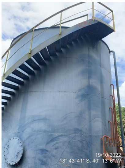
Figura 164 – ETE Residencial Solar
