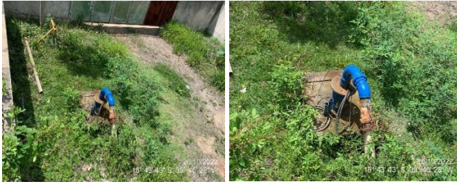
Figura 103 – Poço Subterrâneo Guriri.
