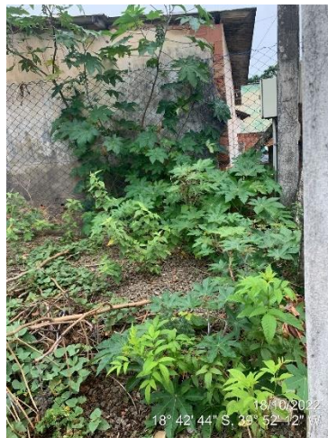
Figura 148 – Excesso de Vegetação.
