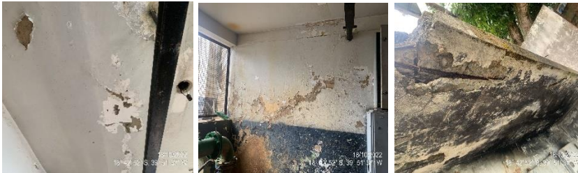
Figura 7 – Estrutura da laje e paredes necessitando de manutenção de reforma na estrutura.
