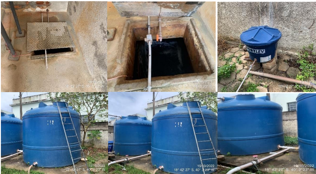
Figura 69 – Reservatório apoiado e Submerso.
