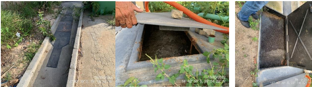
Figura 156 – Tratamento preliminar quase transbordando.
