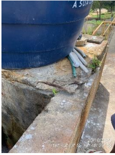
Figura 112 - Vegetação na estrutura da Calha parshall
